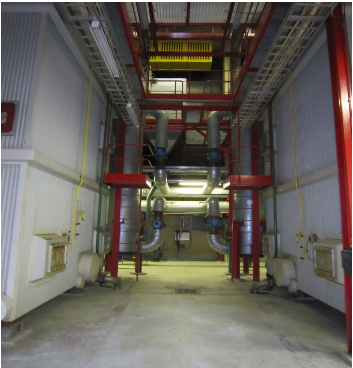
Kuva 8. Lämmönvaihtimet ja niiden haarat kaukolämpötukkeihin
