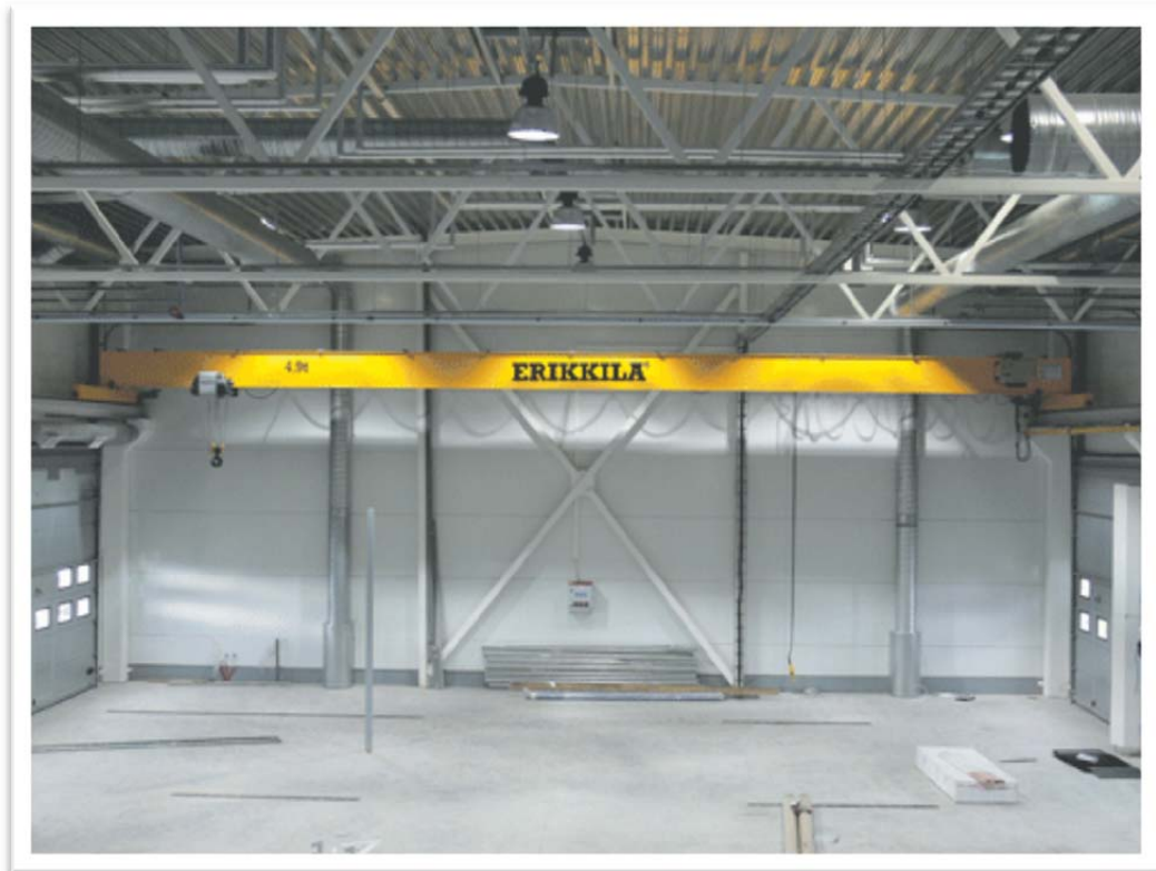
Kuva 6 Siltanosturi, Erkkila Oy
