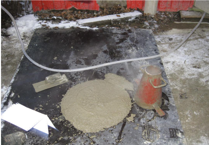
Kuva 5. Betonin painuman/leviämän mittauslaite.
