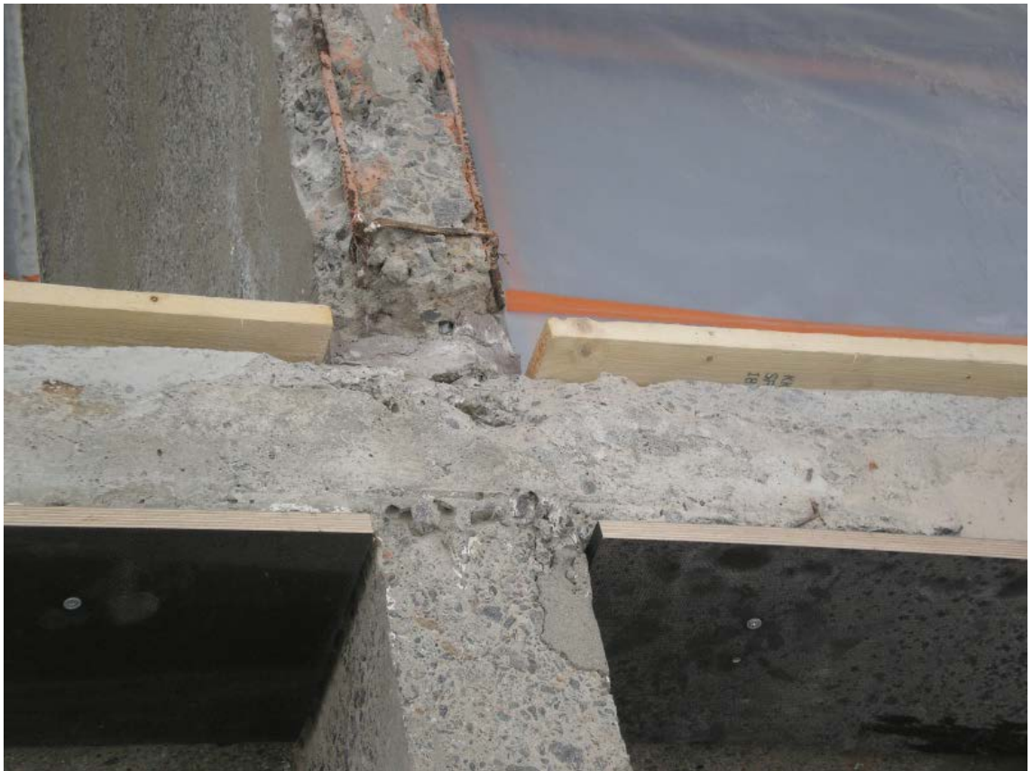
KUVA 39. Teräksen korroosio (RTEK-3730 2009 ,80)
