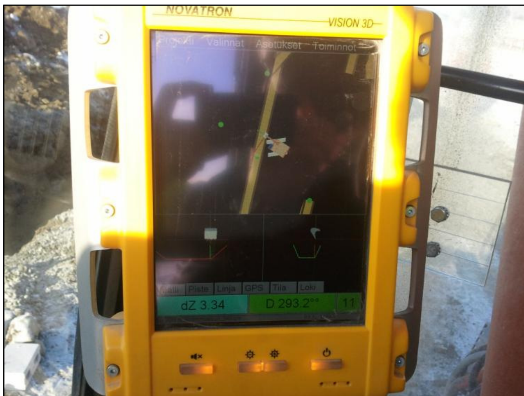
KUVA 31. Viemärikaivannon näkymä laitteiston näytöllä
