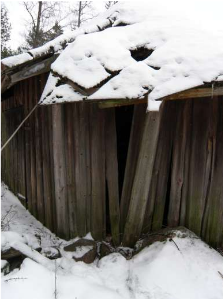
Kuva 2. A- ja B-seinän kulman kohdalla katto on romahtamaisillaan ja laudoituksen yläosa on irronnut. (Sundman 2012)
