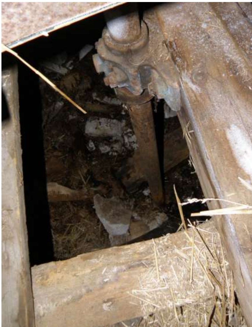
Kuva 10. Kaivon pumppu on ruostunut ja kaivo on täytynyt maa-aineksella ja roskilla. (Sundman 2012)
