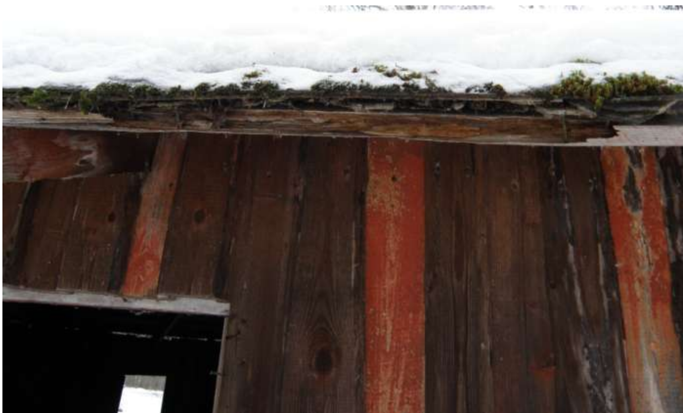
Kuva 5. F-seinässä on jäämiä punamultamaalista. Kuvassa näkyy myös räystäään laho kohta. (Sundman 2012)
