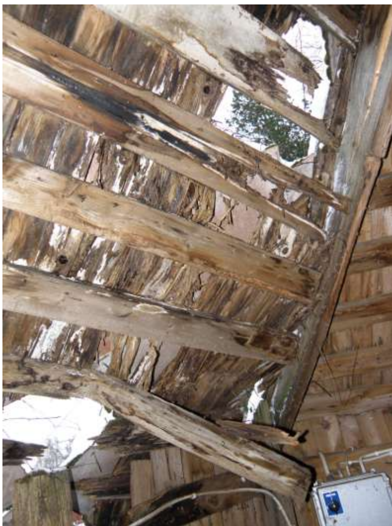
Kuva 8. Lähikuva B-seinän lahovaurioista. (Sundman 2012)
