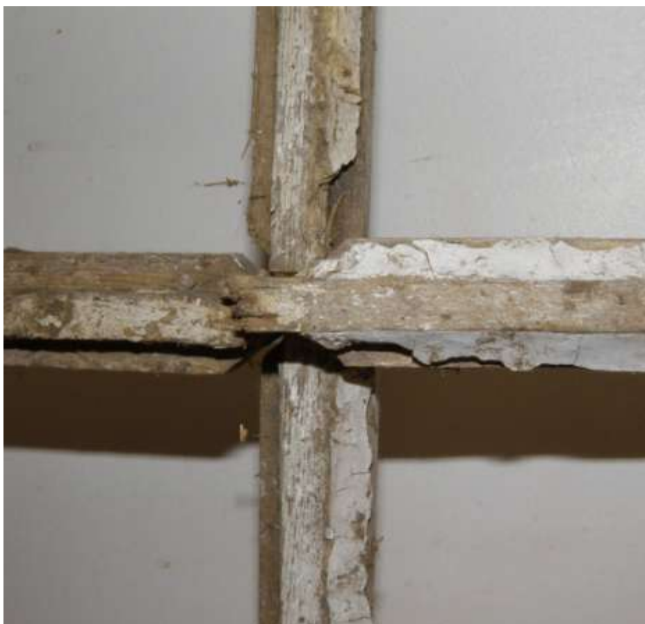
Kuva 13. F-seinän ikkunan murtunut välipuite ulkopuolelta kuvattuna. (Sundman 2012)
