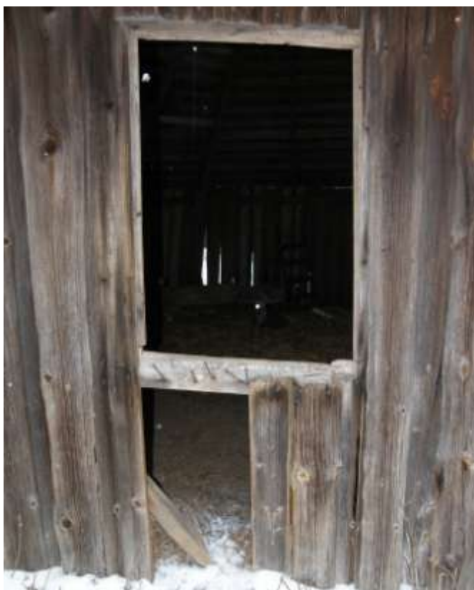
Kuva 3. C-seinästä puuttuu ikkuna. (Sundman 2012)
