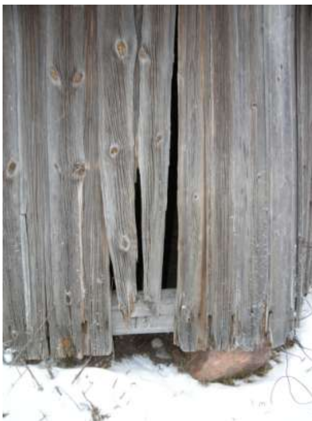
Kuva 4. D-seinässä laudoitus on vaurioitunut. (Sundman 2012)
