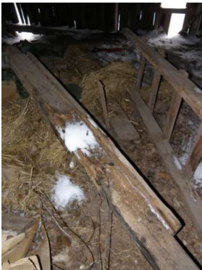
Kuva 12. Aisan keskellä on lahovaurio joka johtuu suoraan sen yläpuolella olevasta reiästä. (Sundman 2012)
