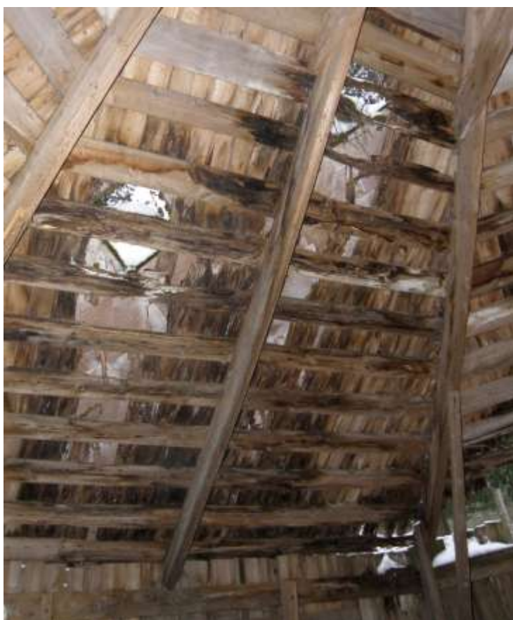
Kuva 7. A-seinän katossa näkyy sisäpuolella mittavia lahovaurioita. (Sundman 2012)
