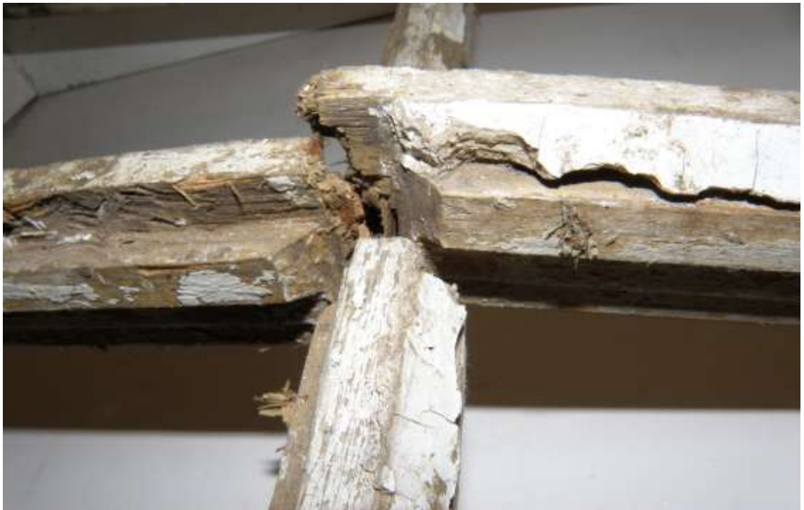
Kuva 6. F-seinän ikkunan murtuneet välipuitteet, tässä ulkopuolelta kuvattuna. (Sundman 2011)
