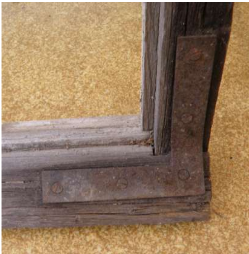
Kuva 14. C-seinän ikkunan alapuitteen ruostunut kulmarauta. (Sundman 2012)
