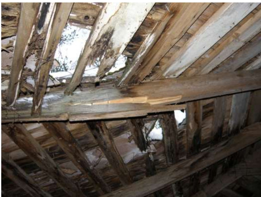
Kuva 9. A- ja B-seinien välisen kulman murtunut kattotuoli. (Sundman 2012)
