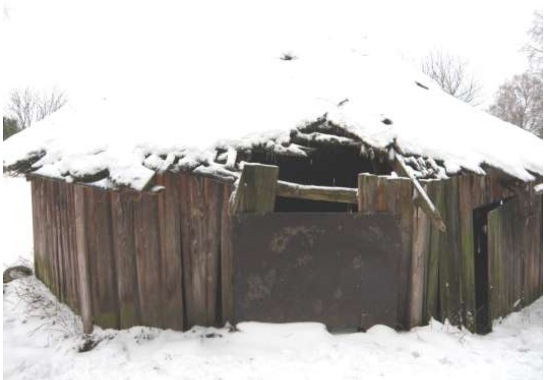
Kuva 4. Kuvassa näkyy seinien H ja A:n välinen kulma. Vauriot ovat huomattavia. (Sundman 2011)
