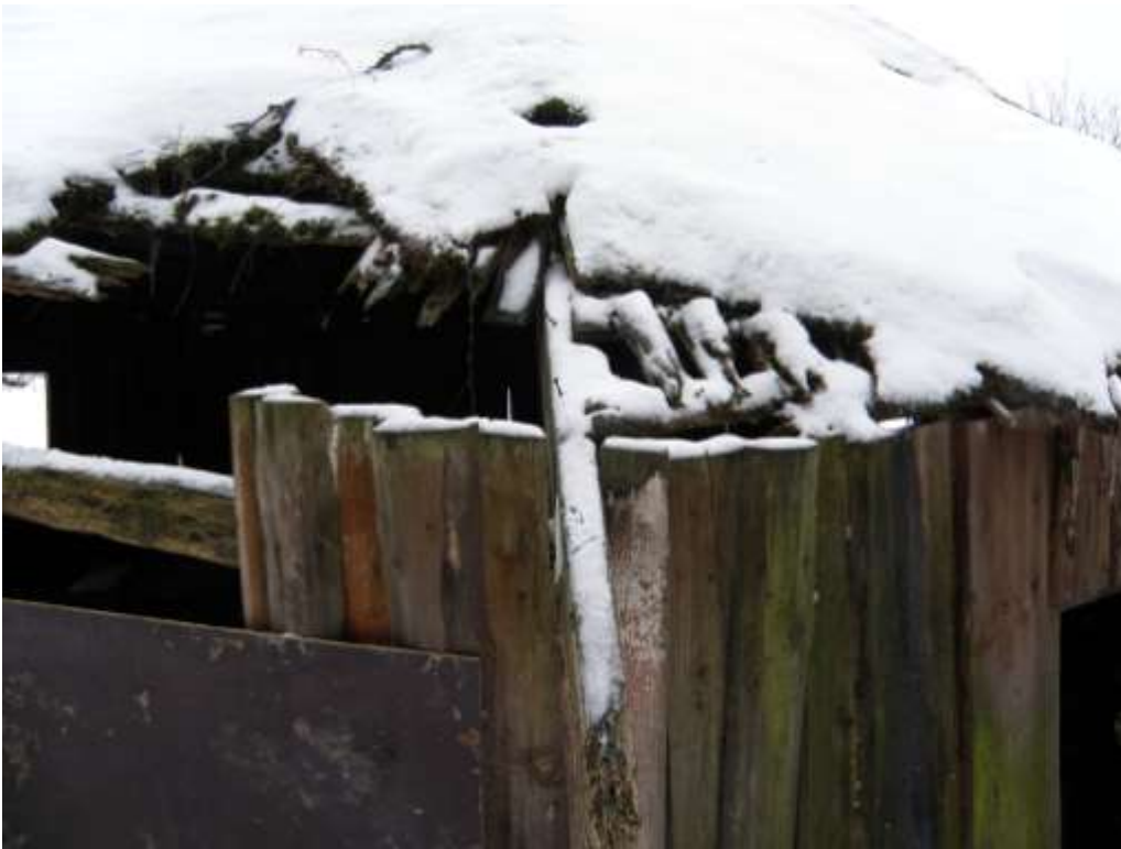
Kuva 1. H- ja A-seinien välisen kulman katosta puuttuu suuri osa räystäästä. (Sundman 2012)
