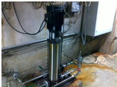
KUVA 8. Paineenkorotuspumppu (Ville Kauhanen)
