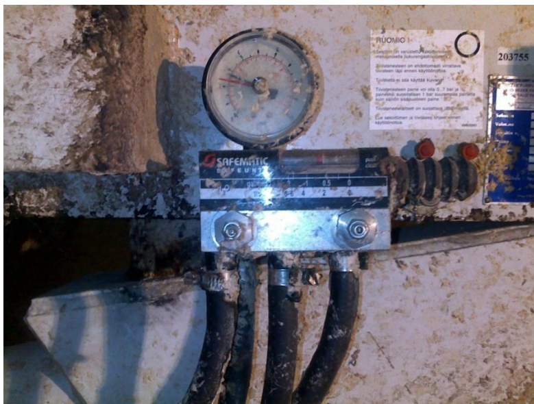
KUVA 3. John Crane Safematic Oy:n virtausvahti (Ville Kauhanen)
