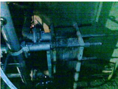
KUVA 6. Lämmönvaihdin (Ville Kauhanen)
