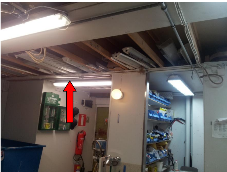
KUVA 6. Kattorakenteisiin varastoidut tuotteet, osoitettu nuolella. (Kuva Matti Kubin)
