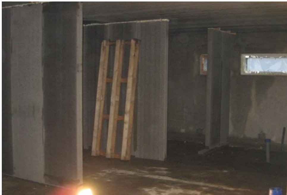
Kuva 5. ACO-väliseinää Katajan työmaalla.
