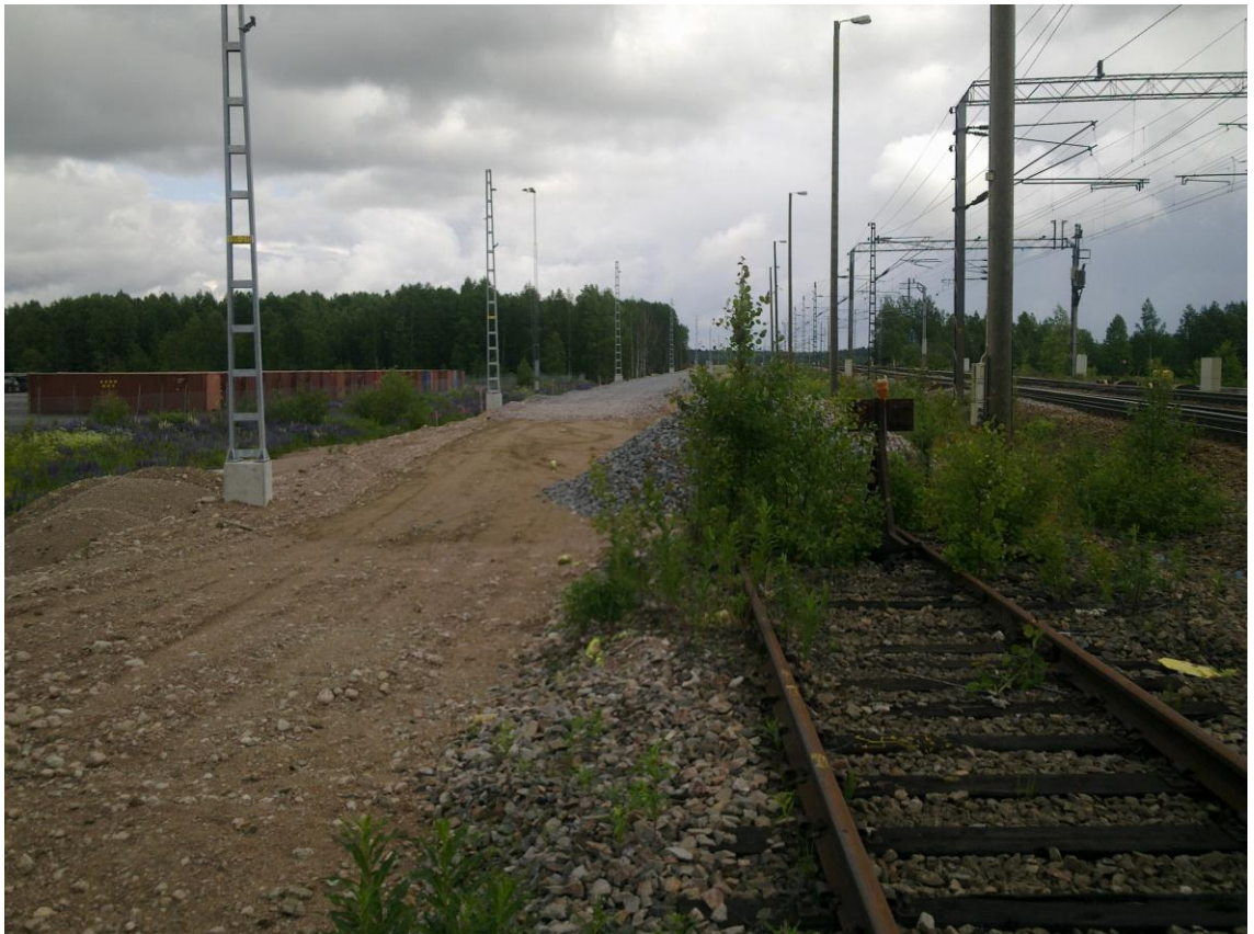
Kuva 9. Uusi ja vanha ratalinja eivät kohtaa. Uuden ratalinjan perustukset rakennettiin koordinaattien mukaan ja linja piti liittää kuvassa näkyvän vanhan pussiraiteen päähän, mutta jokin meni pieleen. (Lalu, Rejlers Oy)
