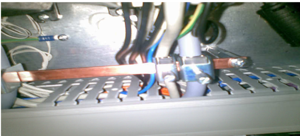
Kuva 19. Kaapleiden veto sähkökaapissa (Nieminen 2011)
