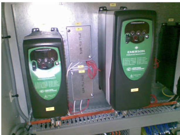
Kuva 16. Asennettu SK-taajuusmuuttajia sähkökaapissa (Nieminen 2011)
