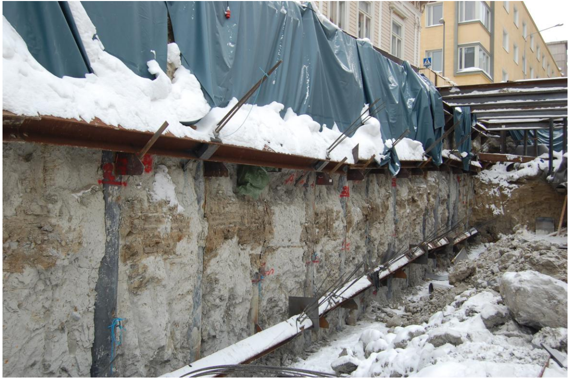
KUVA 2. Kaivannon tuennassa on käytetty porapaalujen ja suihkuinjektointin yhdistelmää. Lisäksi on ankkurointi vaijeriankkureilla. (Lemminkäinen Infra Oy, P-Hämppi, 2010.)
