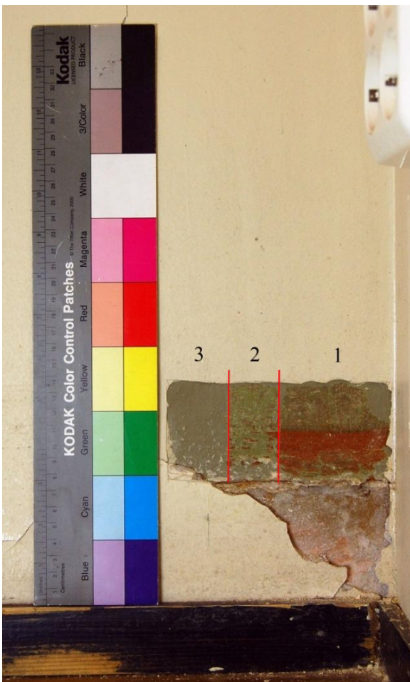
Esilleotto alaseinän vanhimmista värikerroksista (1–3) eteläseinän lattianrajassa. Kuvassa näkyy myös vanhan ja uuden lattialistan korkeusero.
