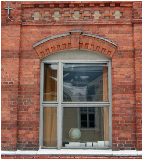
Kuva 21. Ikkunat on vaihdettu rakennukseen sopimattomiksi 1960-luvulla. (Myyrä 2011)
