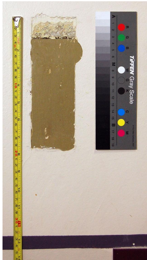
Esiinotto (2) alaseinän tummanvihreästä, mahdollisesti alkuperäisestä kerroksesta. Ala- ja yläseinää jakava, 1,9 m korkeudella lattiasta kulkevan tumman viivan päällä näkyy hieman vaaleankeltaista sävyä, mikä ei pysy kunnolla kiinni alustassa. Vertaa esiinottoa ensimmäisen kerroksen aulan samankaltaisiin esiinottoihin (dokumentointikortit 1 ja 3).
