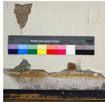
Kuva 71. Irronnutta seinän pintakäsittelyä lattia-rajassa. (Myyrä 2012)
