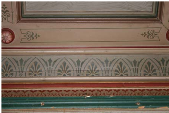
Kuva 24. Uusrenessanssityylisen Lappeenrannan vanhan rautatieaseman, Keisarinaseman, kattopinta on koristeltu värikkäästi ornameinteilla. Keskellä antiikista periytyvä palmetti-aihe (vihreä kuvio). (Kyamk 2010)
