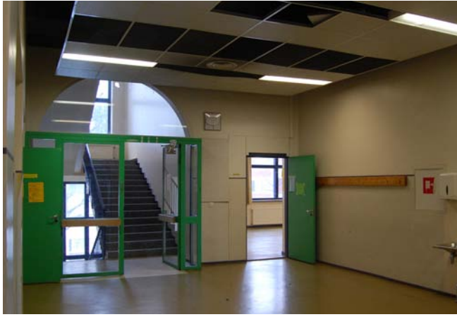
Kuva 22. Toisen kerroksen aula uudella puolella. Kuvassa näkyvät vajereilla lasketut sisäkattolevyt sekä luokkien laaka- ja porraskäytävän lankalasiovet, jotka on lisätty vanhan korkean sisäänkäynnin kohdalle. (Myyrä 2012)
