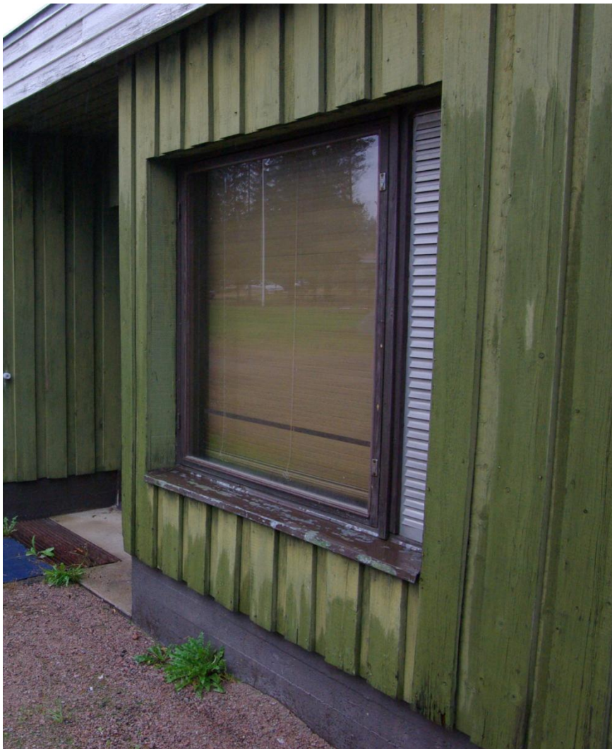
Kuvio 6. Kastunut ulkoseinä.
