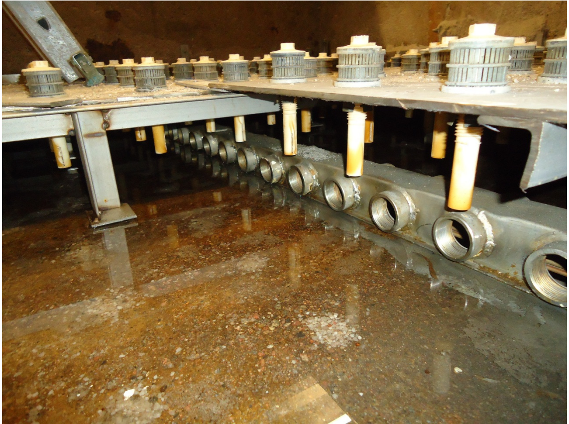
Kuva 16. Purettava suodatinpohja Jyväskylän AaltoAlvari-uimahallissa
