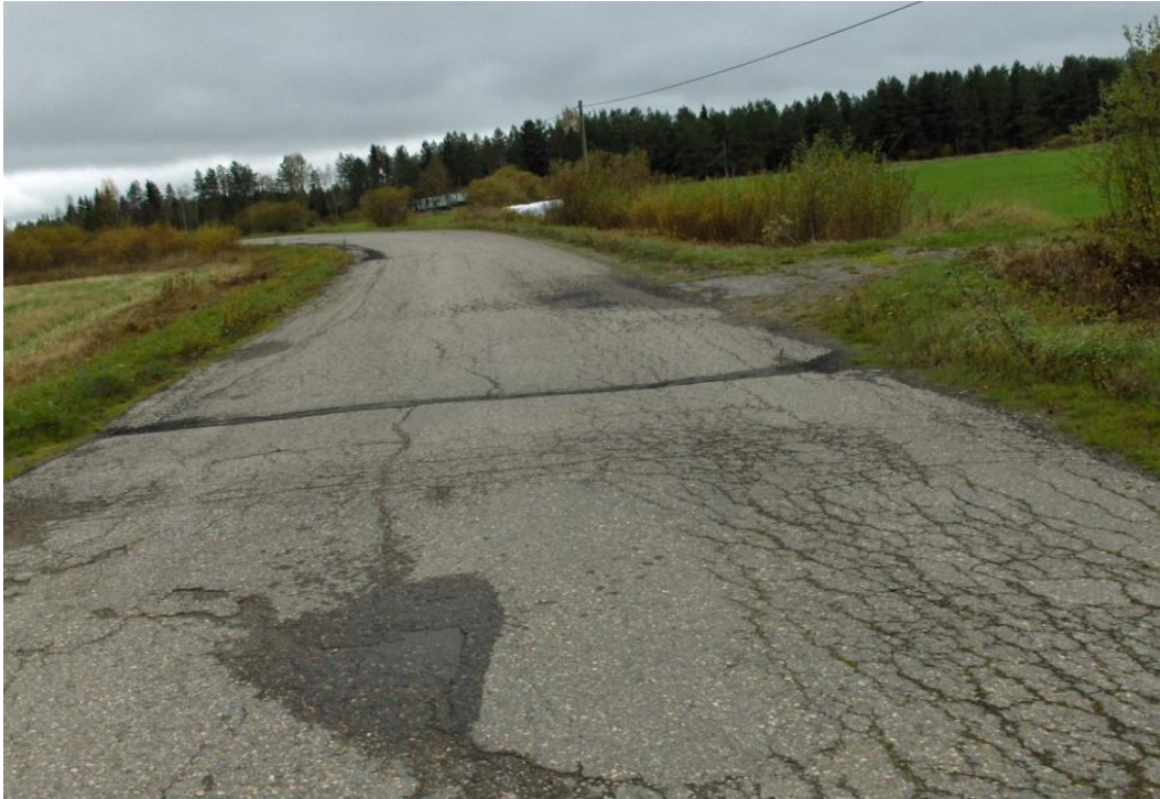
KUVA 11. Pituussuuntaisia ja leveysuuntaisia vaurioita (Piippo 2011)
