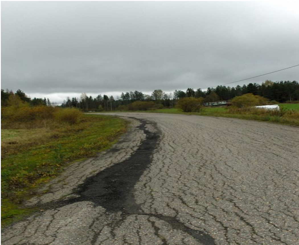
KUVA 3. Pituussuuntainen vaurio (Piippo 2011)
