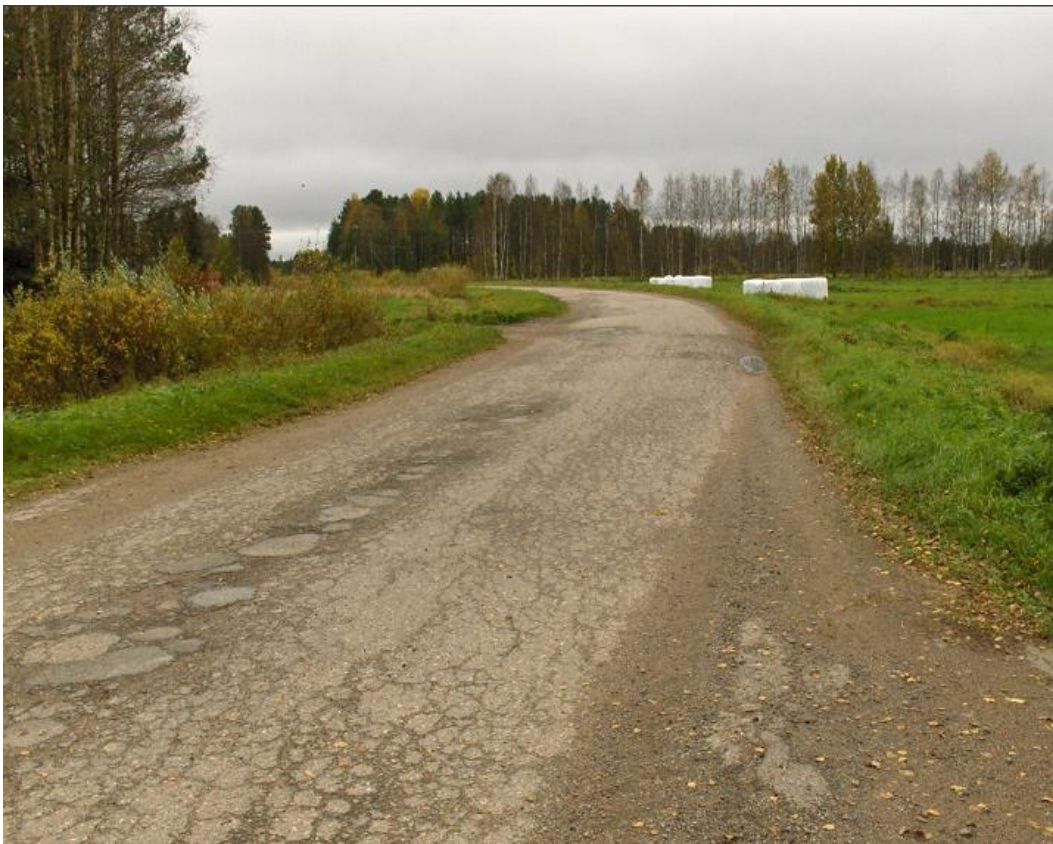
KUVA 4. Tien keskiosassa on reikiä, päällystettä yritetty korjata (Piippo 2011)
