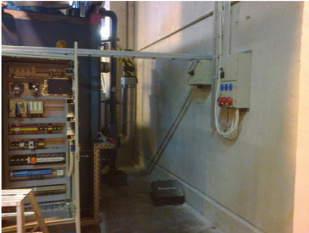
KUVA 9. Päävirtakytin, sähkökaappi ja niiden välinen kaapelikouru
