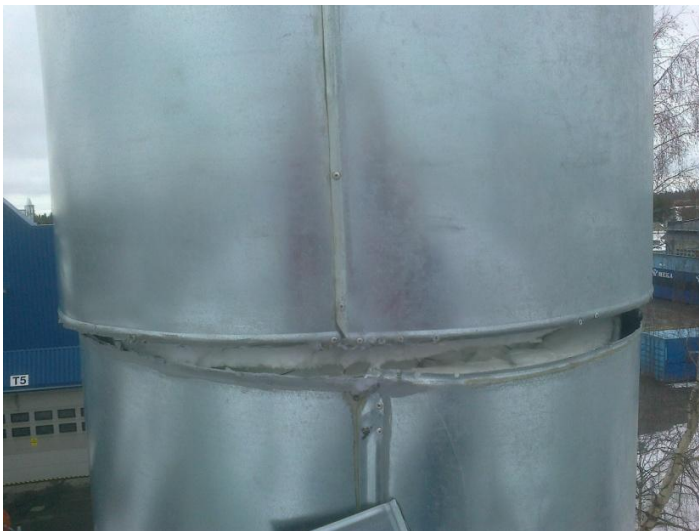
KUVA 14. Piipusta irronneet pellit
