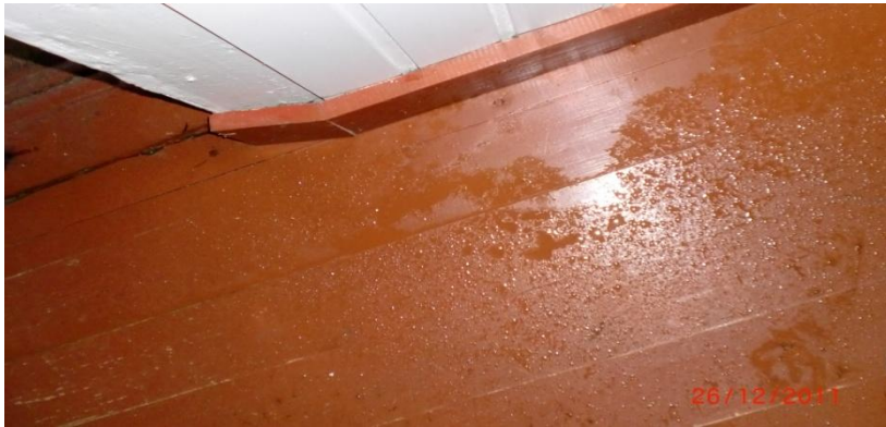
Kuva 35. Päärakennuksen katto on jo niin huono, että vesi valuu välikatosta suoraan keittiön lattialle. Johanna Kallenautio 2011.
