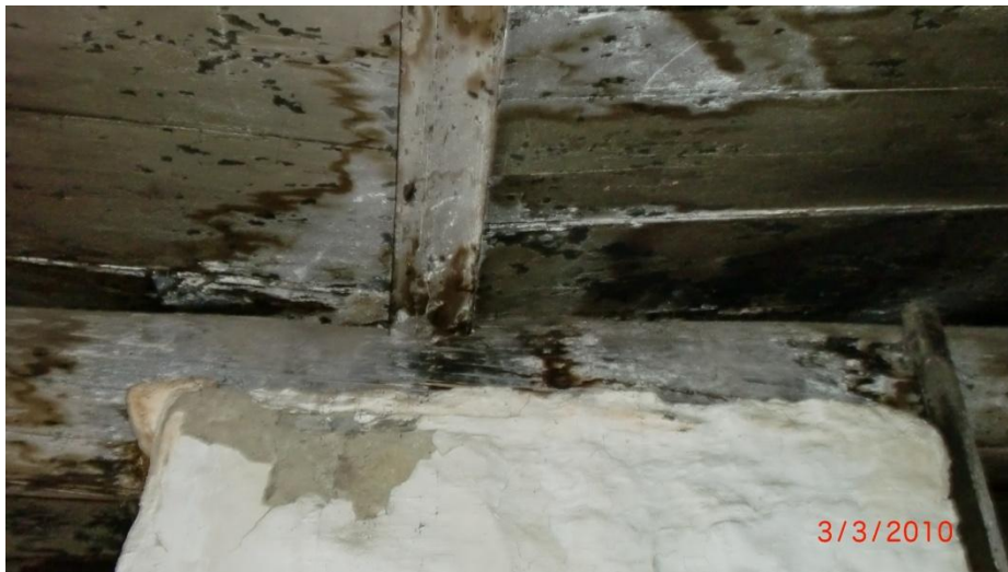
Kuva 37. Painunut kattohirsi painaa takkaa. Laipiossa ja kattohirsissä näkyy valumakohtia, kun aikojen saatossa vesi on päässyt tekemään tuhojaan. Kosteuden ja hirren painumisen vuoksi takan pintalaasti kärsii. On ajan kysymys, milloin kattohirsi antaa periksi ja romahtaa. Kuva Johanna Kalenautio 2010.
