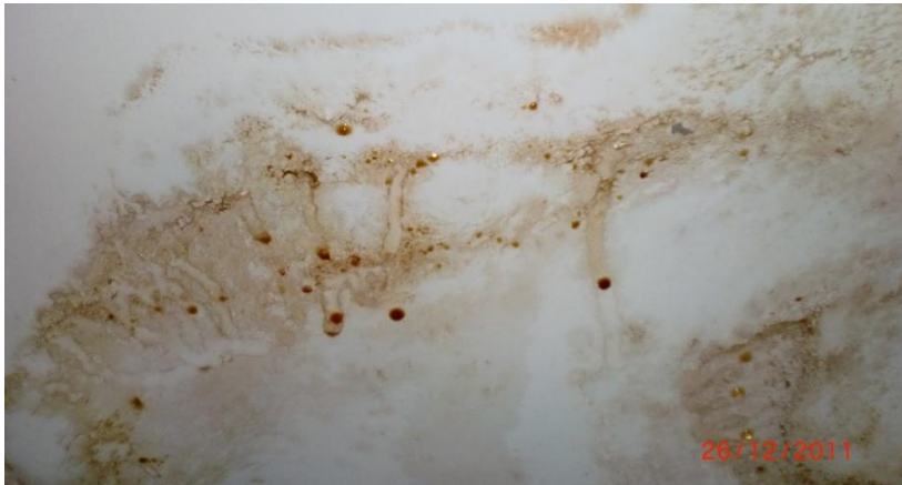
Kuva 34. Keittiön katon kosteusvaurioita. Johanna Kallenautio 2010.
