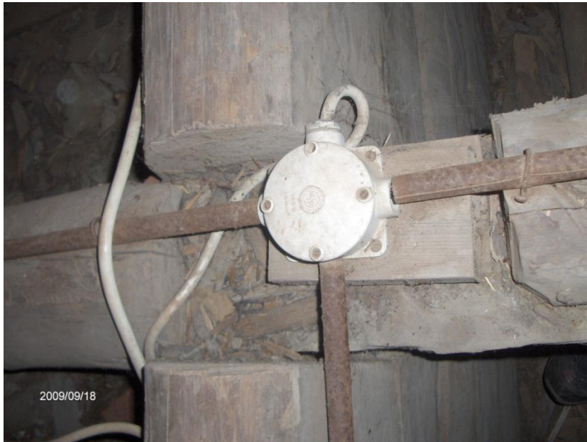
Kuva 33. Päärakennuksen vanhoja sähkökytkentöjä. Kuva Johanna Kallenautio 2009.
