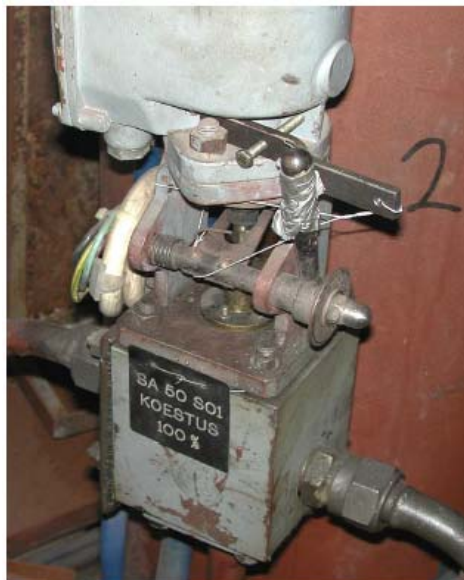
Kuva 19. Pikasulkuventtiilin liikekoestusvipu kiilattuna koestusasentoon. /26/
