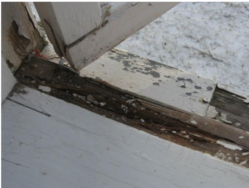
Kuva 16. Eteläpuoleisen ikkunan vaurioitunut karmi.
