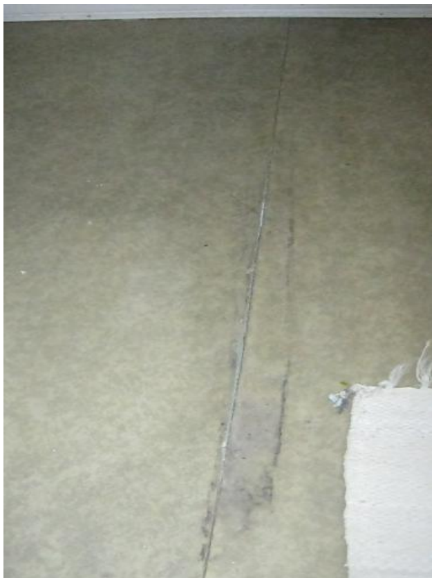
Kuva 10. Idänpuoleisen makuuhuoneen muovimatto on irti alustastaan.
