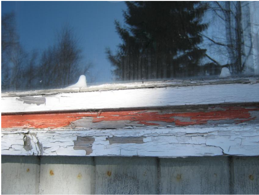
Kuva 15. Ikkunan karmin maalipinta hilseilee eteläpuoleisella julkisivulla.
