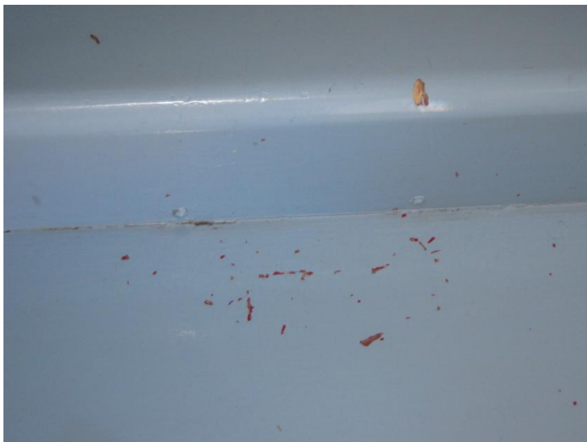
Kuva 17. Sisäportaissa näkyviä kolhuja.
