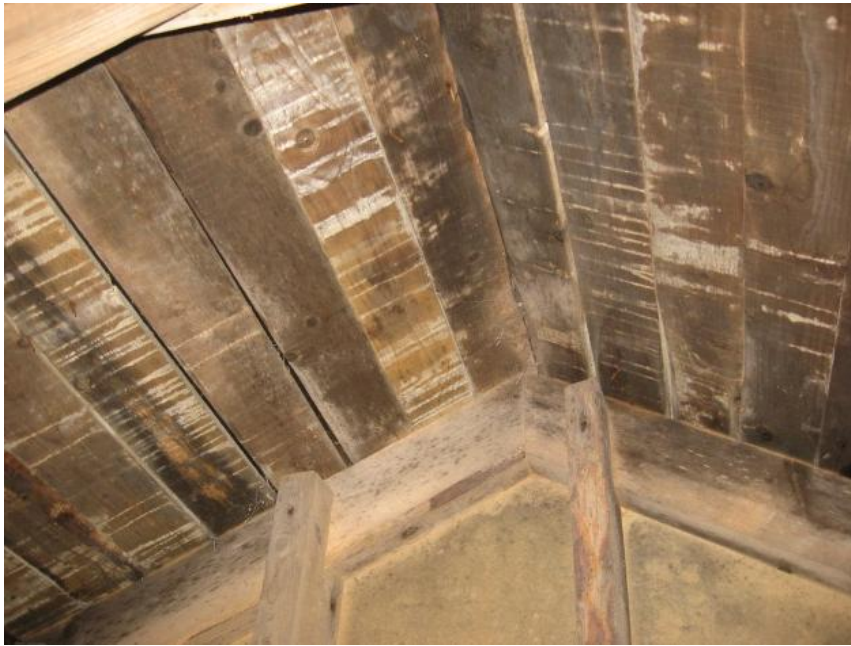
Kuva 20. Vesikaton umpilaudoitus ja tummunutta kattoniskaa.
