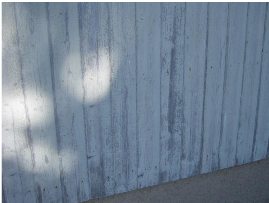
Kuva 3. Etelänpuoleisen julkisivun maalipinta hilseilee.
