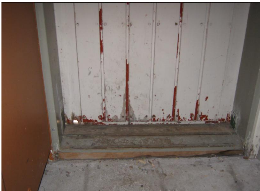
Kuva 14. Takkahuoneen ovessa on reikä.
