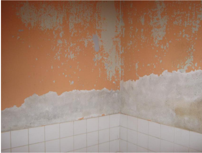
Kuva 8. Pesuhuoneen väliseinän klinkkerilaatta ja hilseilevä maalipinta.
