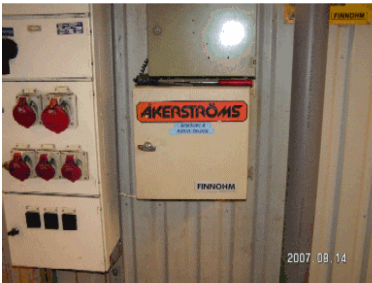
Kuva 5. Siltanosturi 6 ohjaimen säilytyskaappi SZ2 -valvomon alla /2/
