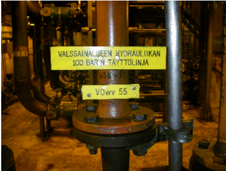
Kuva 60. Imupuolen venttiili, 100 bar täyttölinja
