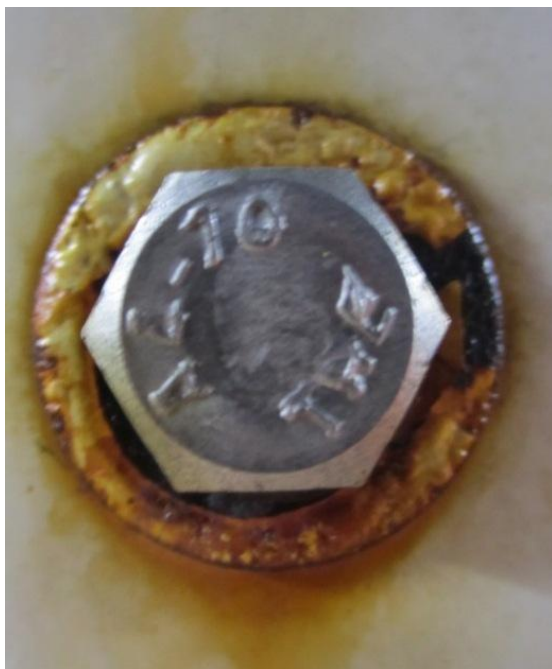
Kuva 8. Korroosion syövyttämä kiinnitysosa
