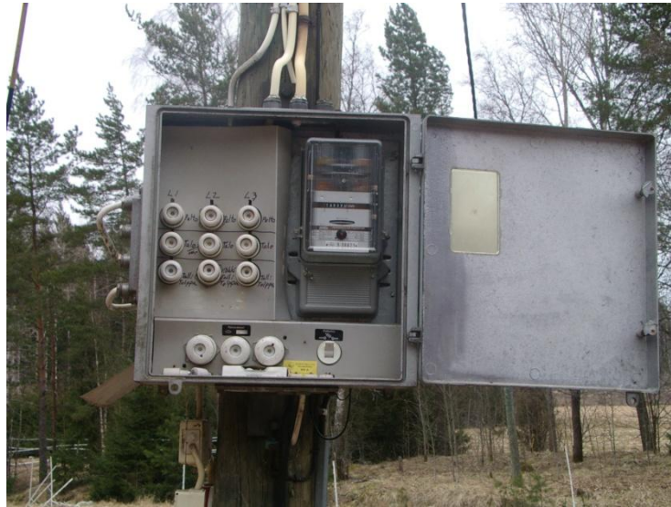
Kuva 4. Pylväässä ulkona sijaitseva pääkeskus.
