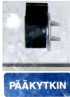
Kuva 5. Sähköpääkeskuksen pääkytkimen merkintä.
