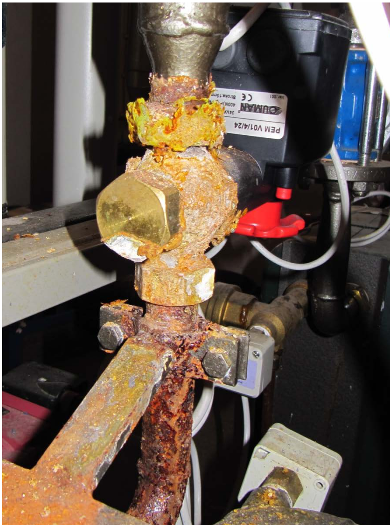
KUVA 5. Lämmityspiirin säätöventtiilin liitos vuotaa
