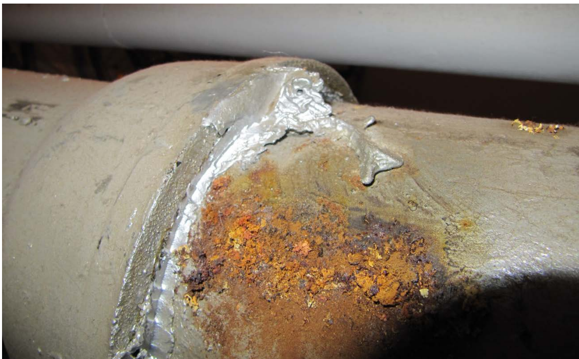
KUVA 7. Valurautaviemärin liitos, joka on mahdollisesti uudelleen tiivistetty
