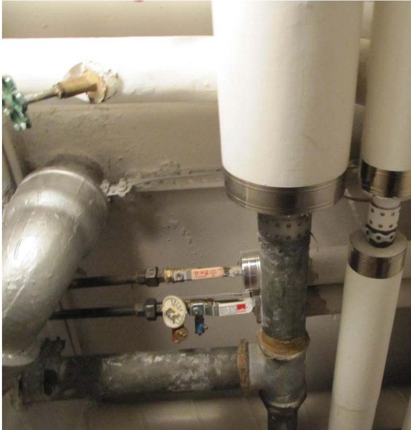
KUVA 3. T-haara kylmävesijohdossa on yleinen ongelmakohta
