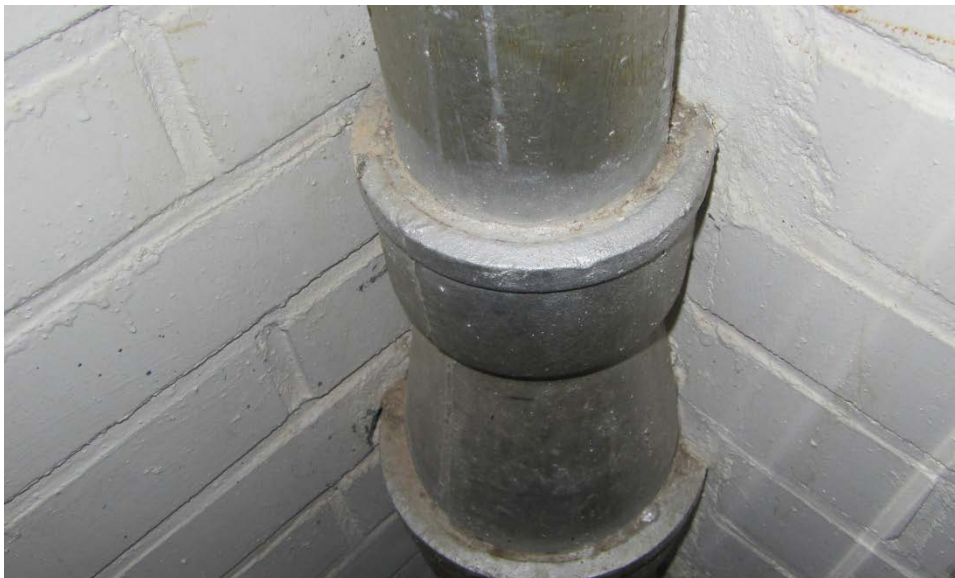
KUVA 9. Valurautaviemärin muhviliitos, joka on pysynyt paikallaan
