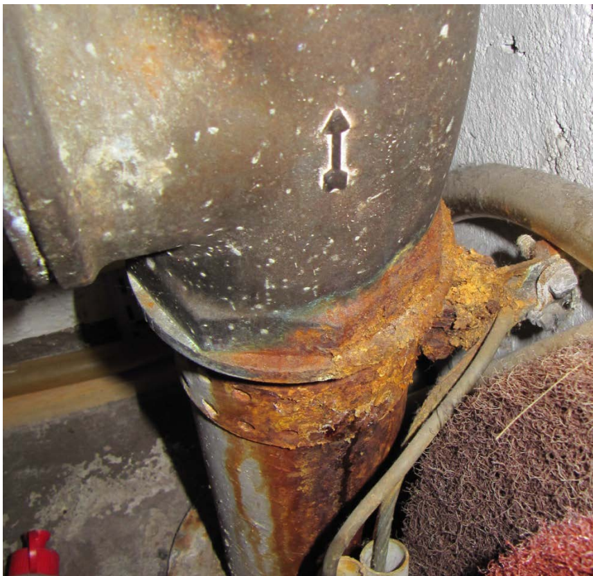
KUVA 2. Korroosiota päävesijohdon liitoskohdassa
