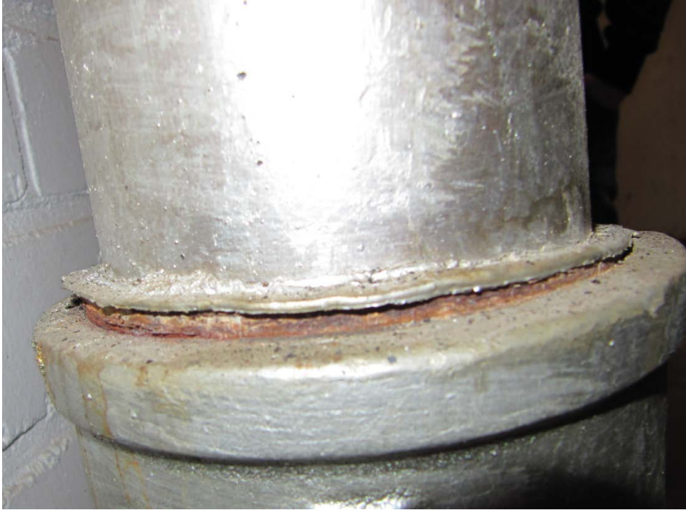
KUVA 8. Valurautaviemärin muhviliitos, joka on noussut pois paikaltaan
