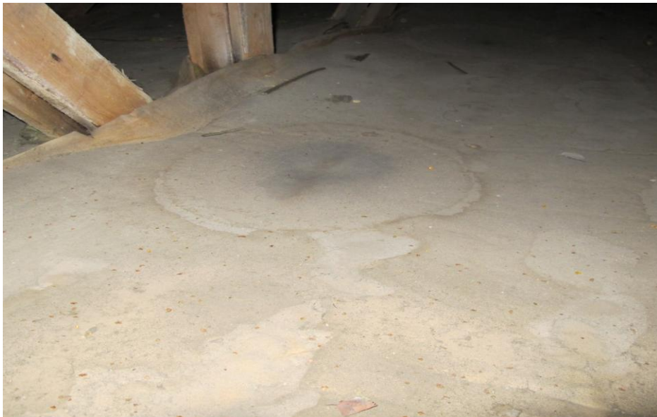
KUVIO 18. Veden tippumiskohta yläpohjaeristeissä
