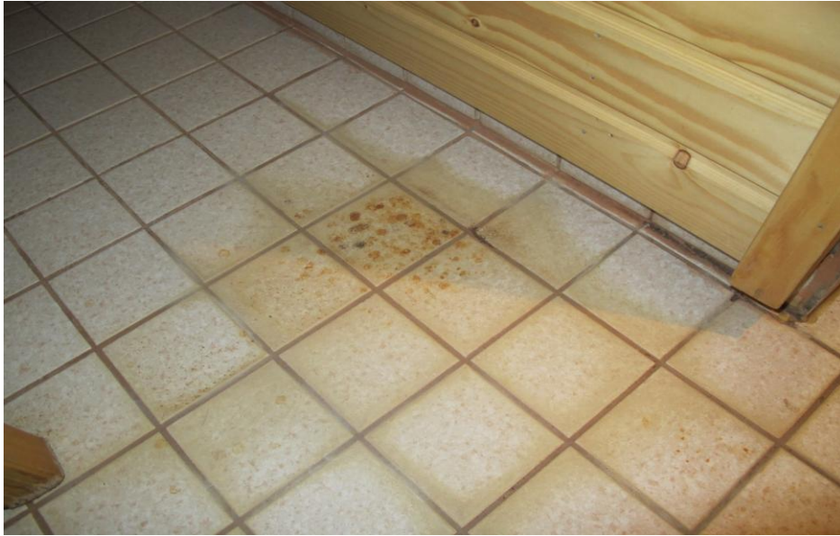
KUVIO 29. Veden lammikoitumiskohta saunassa
