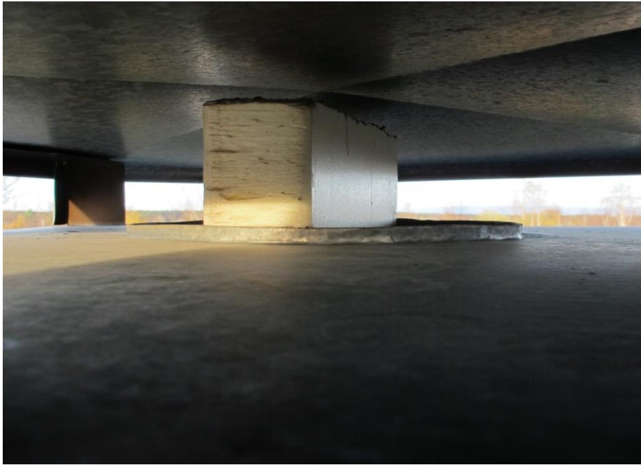
KUVIO 9. Huoneistojen yhteisessä IV-kanavassa oleva solumuovieristelevy
