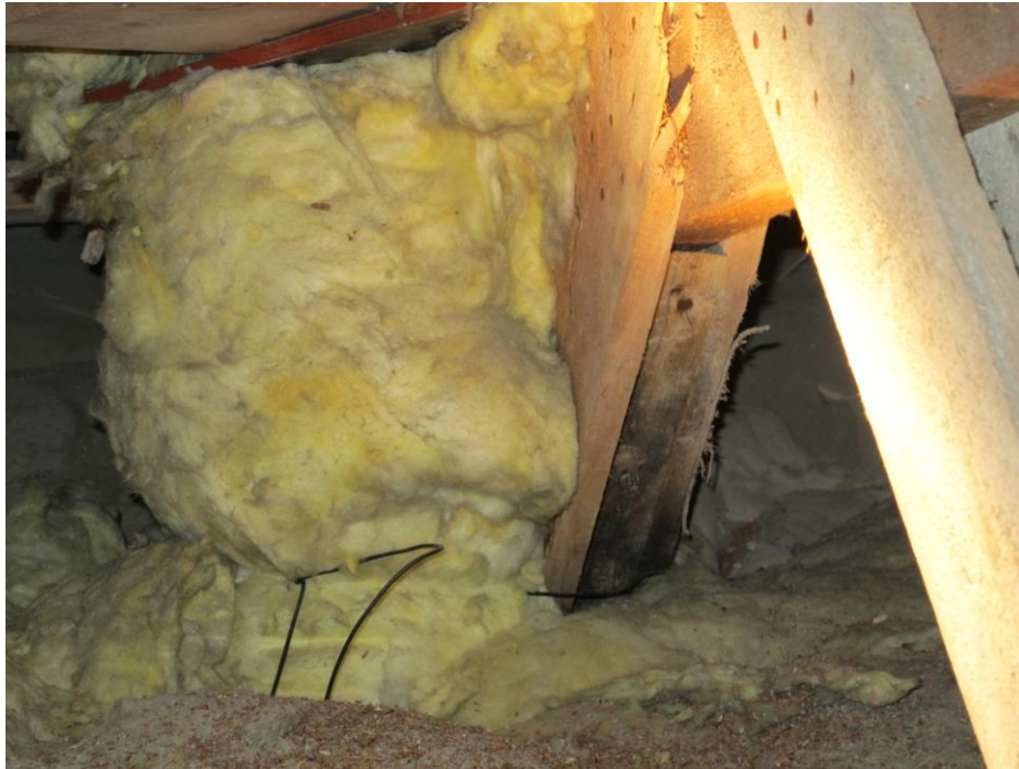
KUVIO 11. Liesituulettimen poistokanavan eristeet
