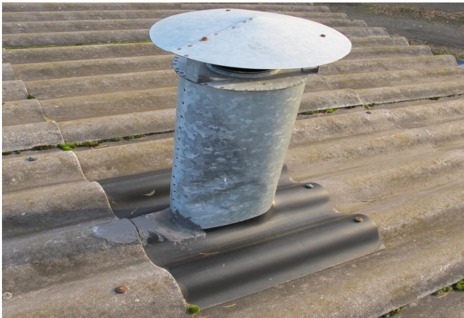
KUVIO 20. Liesituulettimen poistokanavan läpivienti
