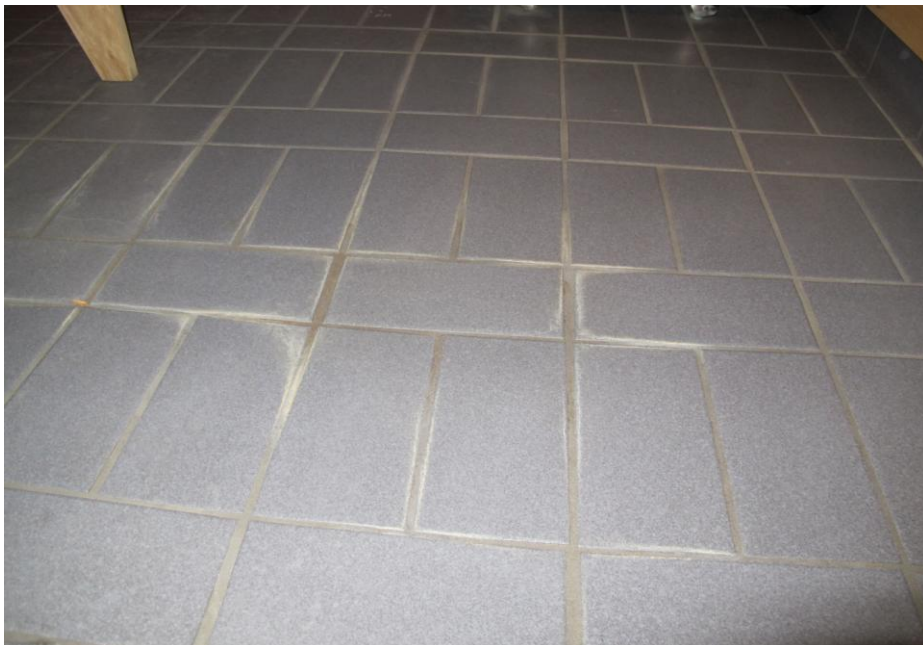
KUVIO 30. Veden lammikoitumiskohta saunassa
