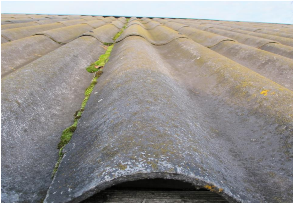
KUVIO 19. Vesikatteen sammaloituminen
