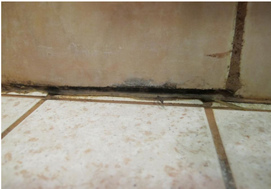
KUVIO 28. Kylpyhuoneen lattian ja seinän välinen silikonisauma
