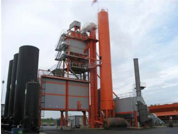
KUVIO 7. Asfalttitehtaan bitumisäiliöt kuvassa vasemmalla. (KH-Koneet Oy 2012.)
