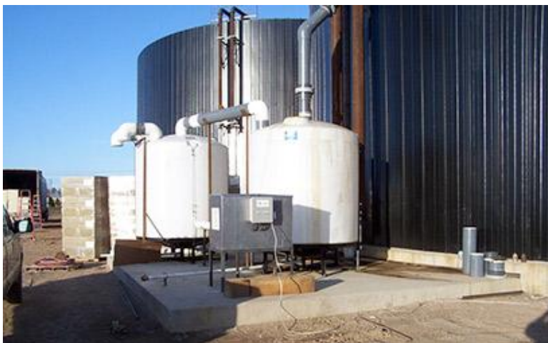
KUVIO 9. Bitumihöyryjen pesurilaitteisto (OMI industries 2012.)
