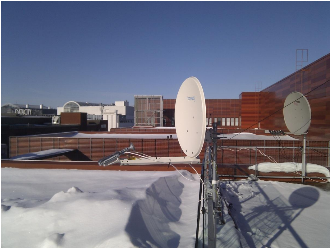
Kuva 2. Tooway-antenni ja mikropää.
