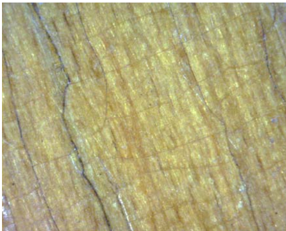
Kuva 7. Krakeloitunutta lakkapintaa Dino-Lite –kuvassa 1
