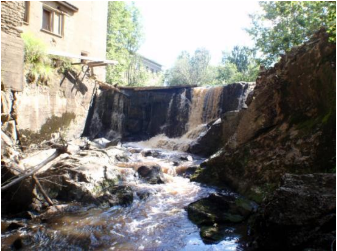
Kuva 59. Pyykosken niskalla sijaitseva pato.
