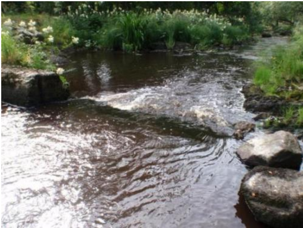
Kuva 8. Pääuoman niskalla sijaitseva vanha settipato, jonka oikeanpuolinen tukipylväs on vaurioitunut.
