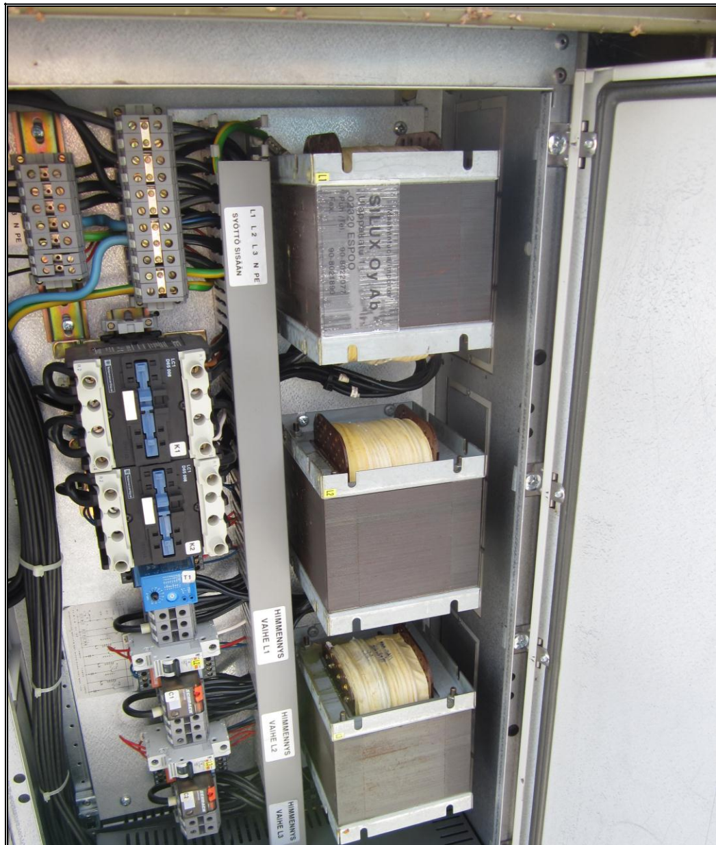
Kuva 11. Säästömuuntajat katuvalokeskuksessa Karjalahdella
