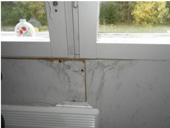
KUVA 12. Yläkerran seinän kosteusvaurio ikkunan alla.
