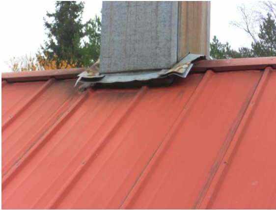
KUVA 15. Piipun juuri, vesikatolla.
