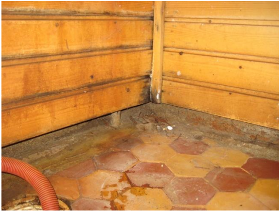
KUVA 18. Pesutilan panelointi, suihkunurkasta.
