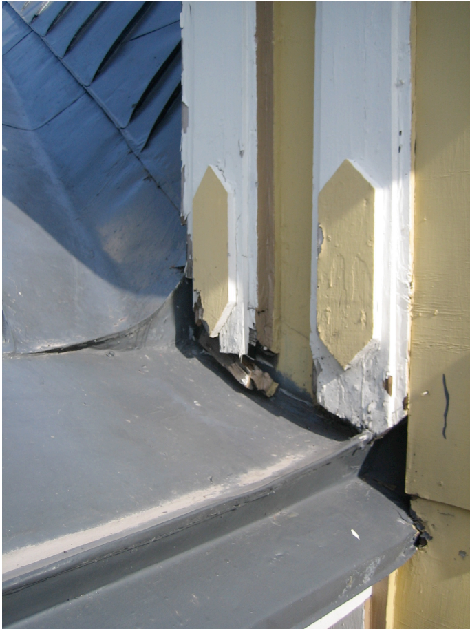
Kuva 9. Sisäjiirin alapään vuotokohta (Niinikoski 2012b.)
