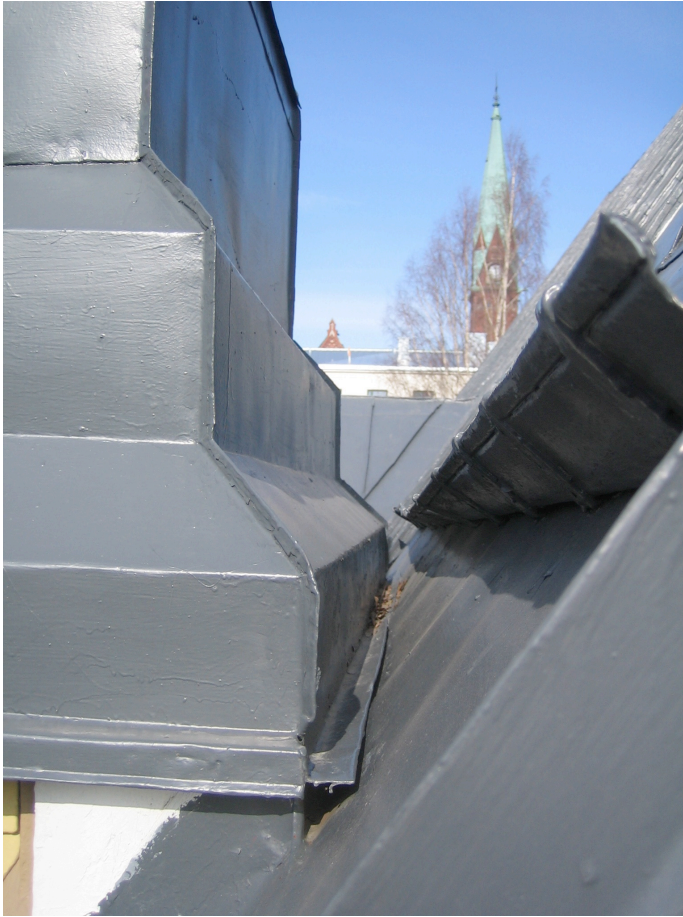
Kuva 8. Jalkarännin ja tornin väliin pakkautuva lumi ja jää löytävät sulaessaan tien katteen alle ja siitä edelleen yläpohjan rakenteisiin (Niinikoski 2012b.)
