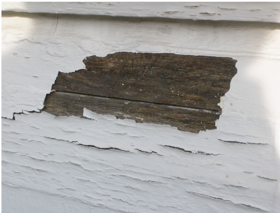
Kuva 14. Sisältä ulospäin haituva kosteus on puskenut maalipinnan halki (Niinikoski 2012b.)
