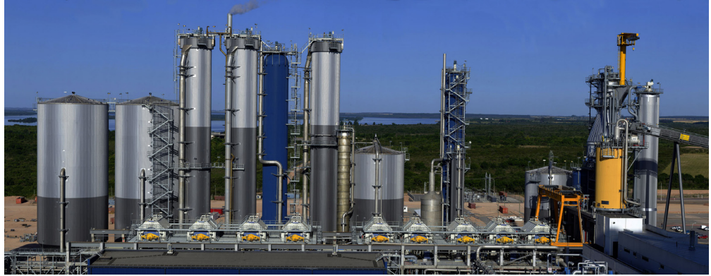
Kuva 2 Andritzin toimittaman UPM Uruguayn tehtaan kuitulinja
