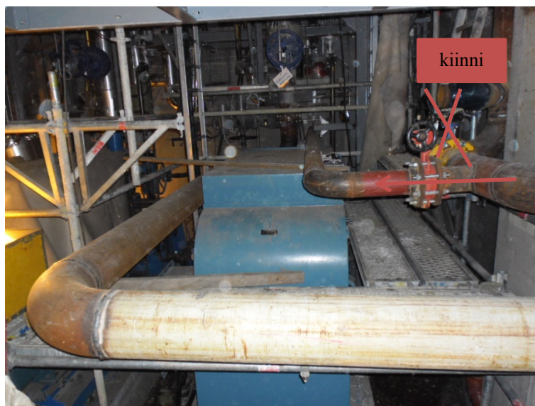
Kuva 33. Kaasukattilan syöttövesipuolen lämmitys
