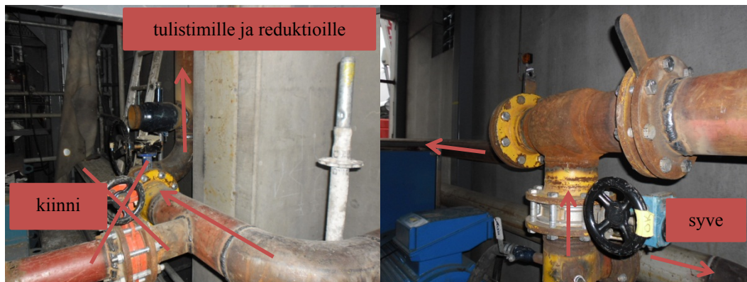
Kuva 32. Reduktio- ja tulistinlinjojen lämmitys
