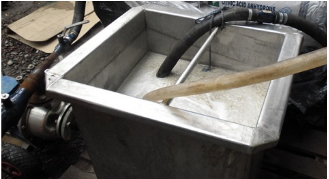
Kuva 8. Kemikaalien annosteluastia- ja pumppu
