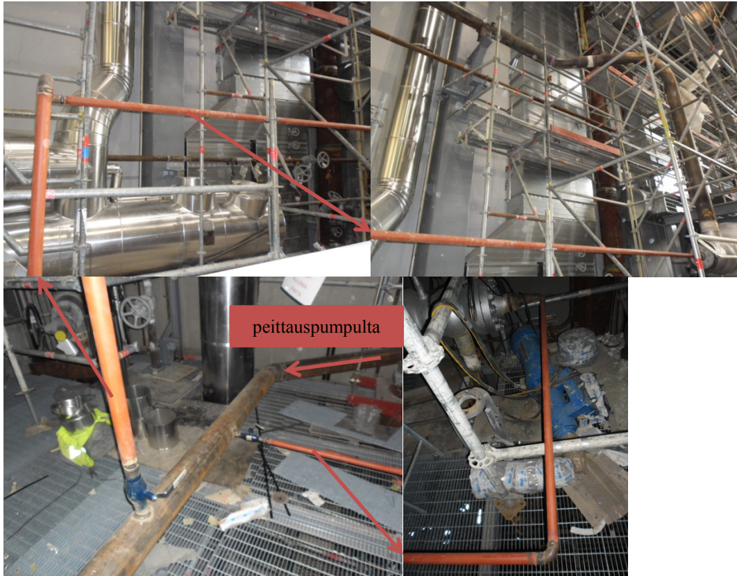
Kuva 31. Turbiinin reduktiolinjojen kytkennät
