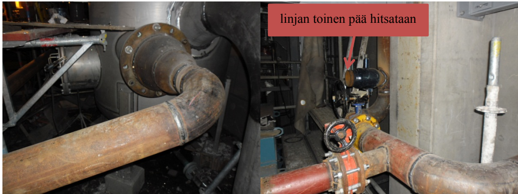
Kuva 29. Turbiinin ulospuhalluslinjan kytkentä
