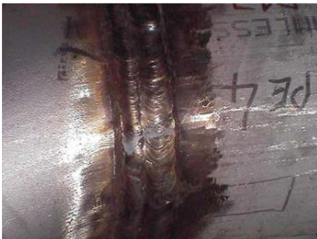
Kuva 9. Hitsattu ruostumaton teräsosa “hitsaus tilassa”: oksidikerros johtaa korroosioon, jos sitä ei poisteta perusteellisesti./17/
