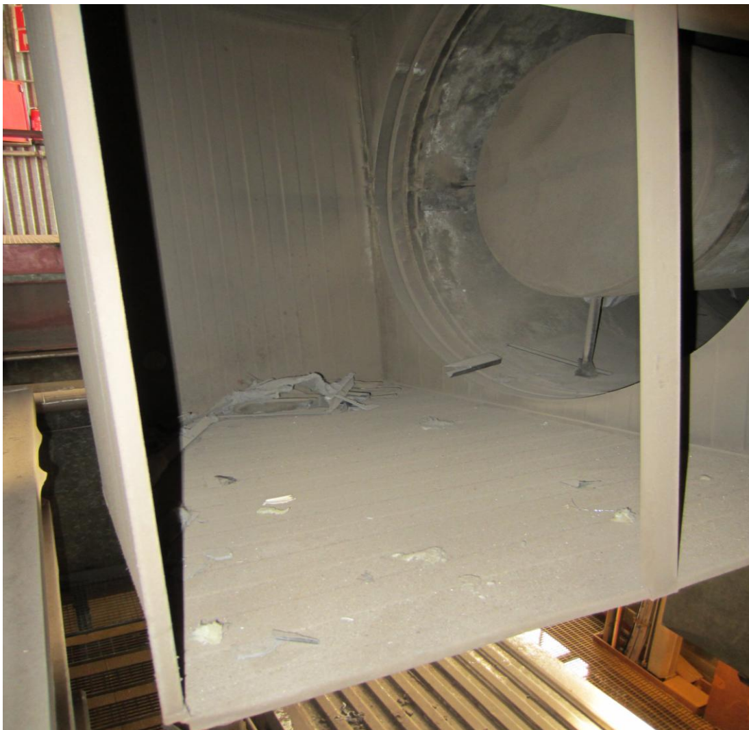
Kuva 17. Puhaltimen TK 5 tuloilmakanava
