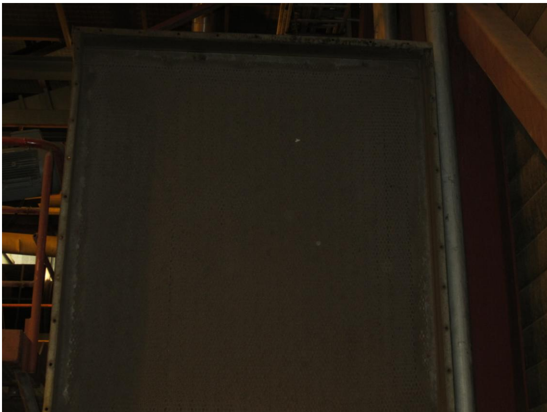
Kuva 18. Tukkoinen imuilmakanava puhaltimen TK 3 kyljessä
