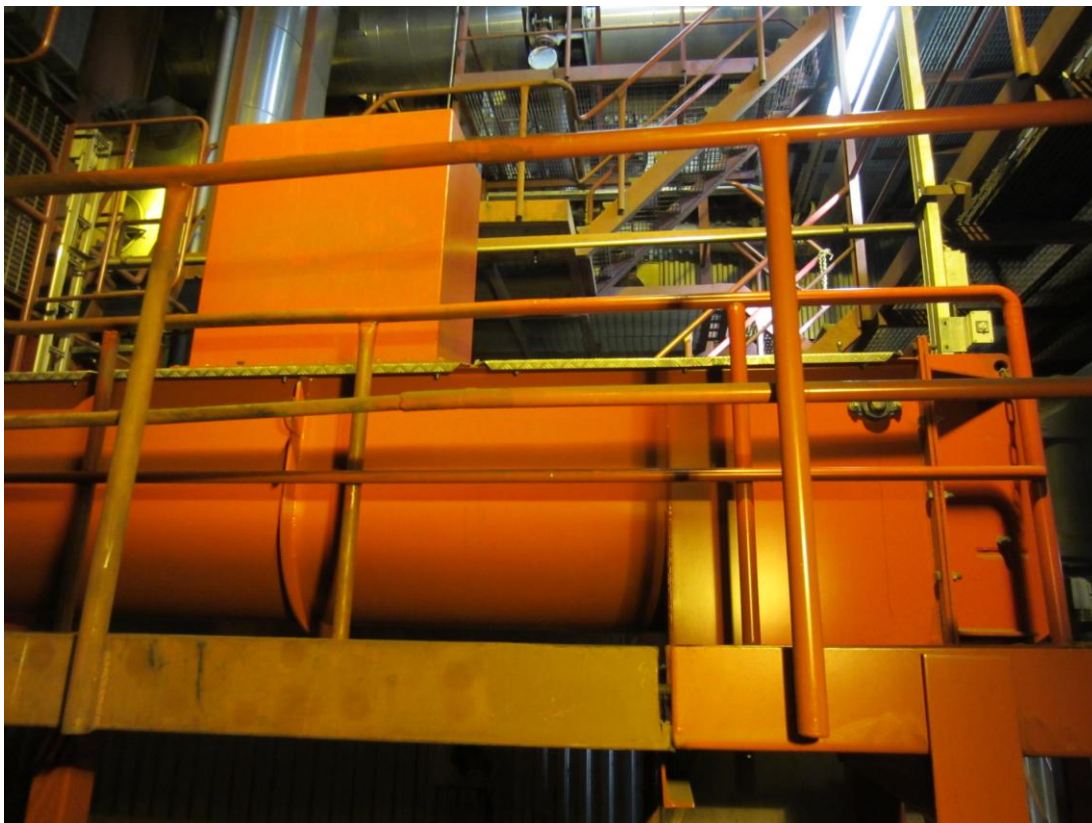
Kuva 20. Ruuvikuljetin 3(NX 50) kattilan vasemmalla seinällä
