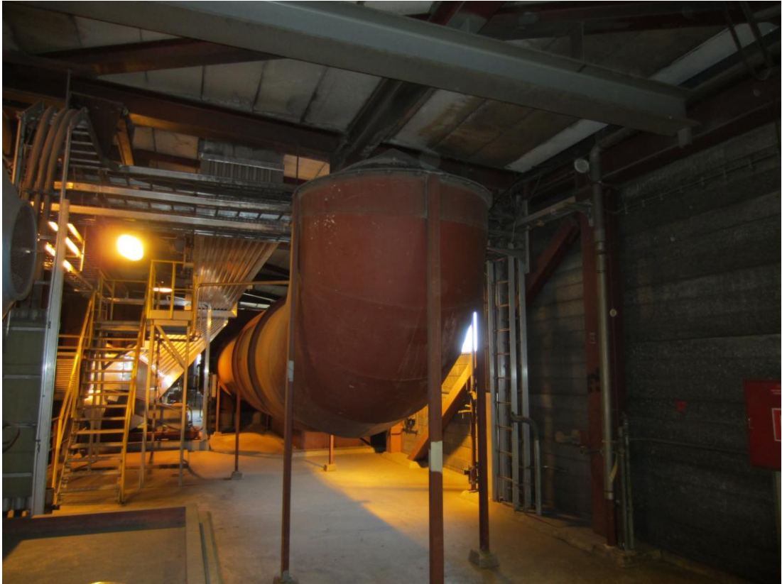
Kuva 14. Sekundääri- ja tertiääri-ilmapuhaltimen imukanava kerroksessa 8
