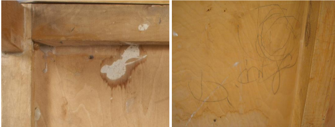
Kuvat 38 ja 39. Vasemmalla liimaroiskeita, purukumi ja valkoista materiaalia pöydän alapuolelta. Irtonainen reunalista näkyy kuvassa ylhäällä. Oikealla lyijykynäsotkua.
