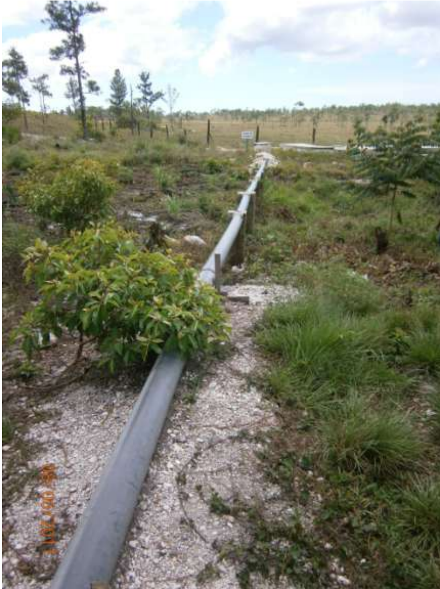
KUVA 8 Putki, jota pitkin orgaaninen aines johdetaan kivisuodattimeen. (Pietilä 2011)
