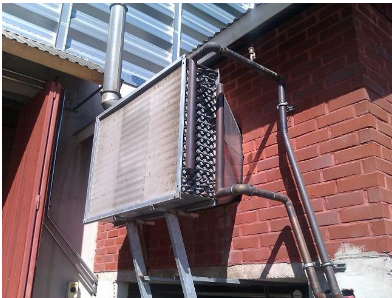
Kuva 2. Lämmönsiirrin Rovion tilalla kuivurin kuivausilma-aukon edessä (Ruohomaa 2012)
