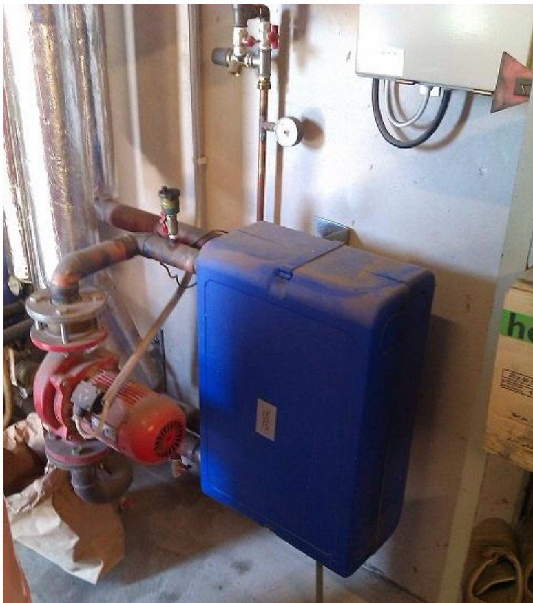
Kuva 1. Lämmönvaihdin lämpökeskuksessa Rovion tilalla. (Ruohomaa 2012)
