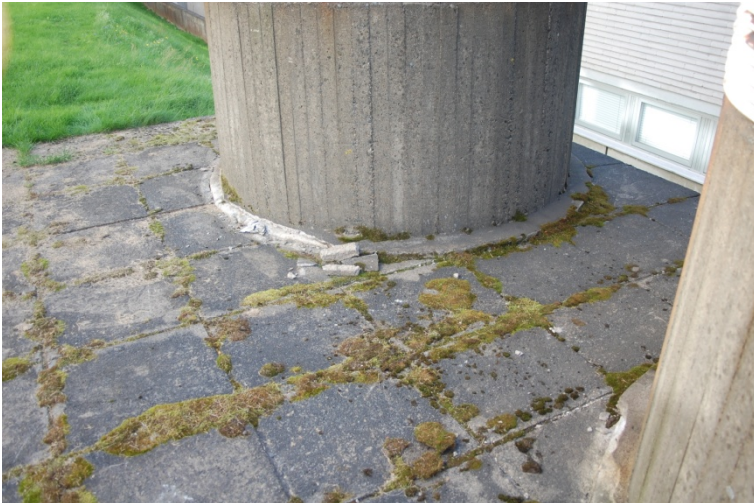
Kuva 5 Pinnoitteet ja ilmastointilaitteet ovat heikkokuntoisia.
