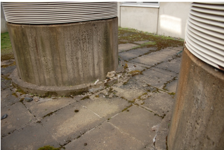
Kuva 19 Laitteistojen rappauksen kunto on heikko.
