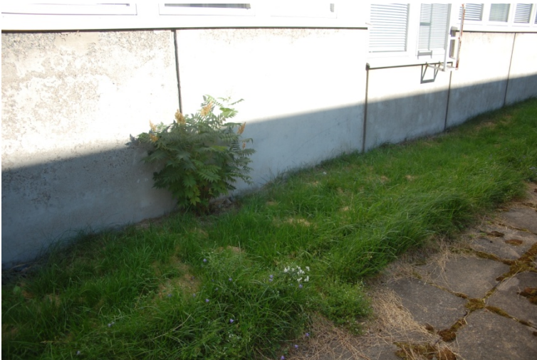
Kuva 32 Kasvillisuus kasvaa osittain suoraan seinänvierustasta.
