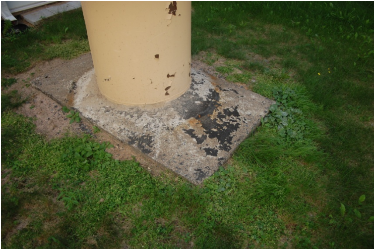
Kuva 10 Jäähdytyslaitteistojen maalipinta ja pinnoite ovat heikkokuntoisia.
