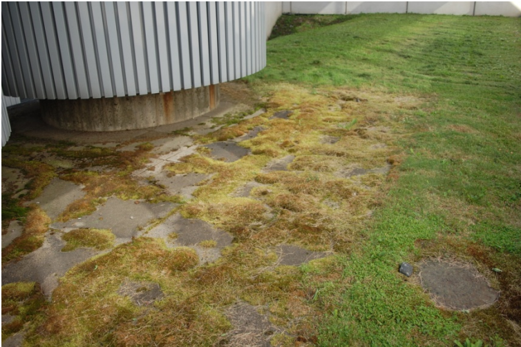
Kuva 26 Kivipinnat kaipaavat uusimista piha-alueella.
