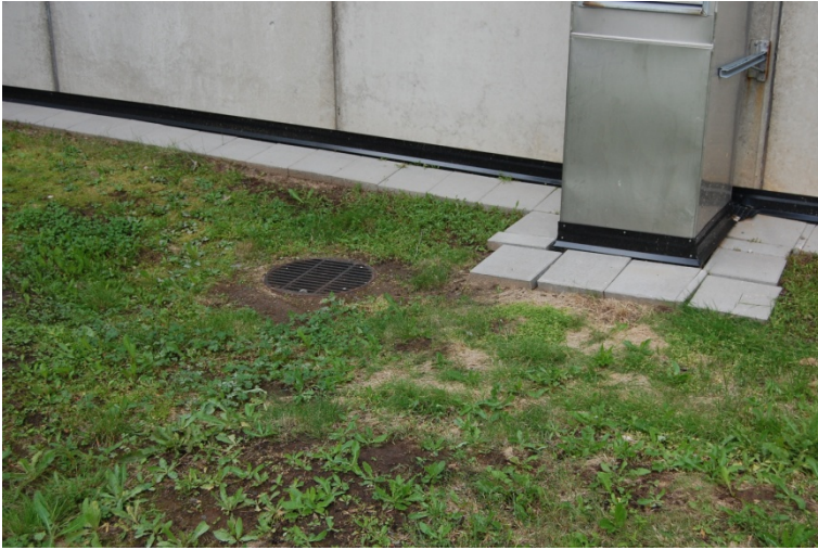
Kuva 1 Pihalle alueen kiveykset on osittain huonosti asennettuja.
