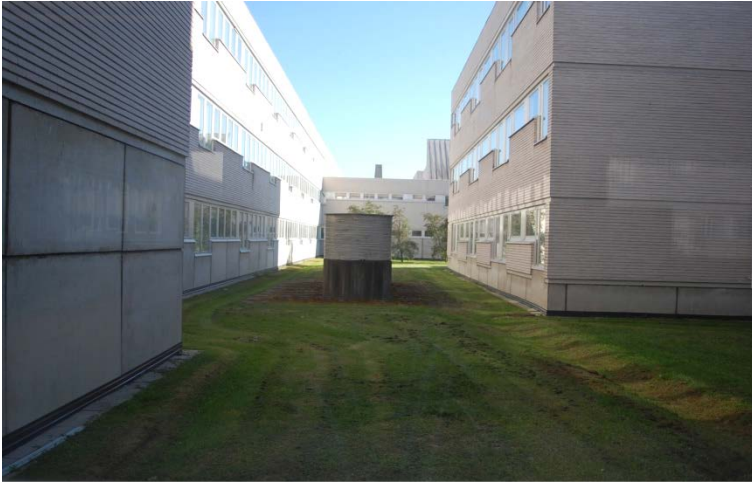
Kuva 20 Sisäpiha-alueen ilmastointilaitteiden maali- ja rappauspinta on huono.
