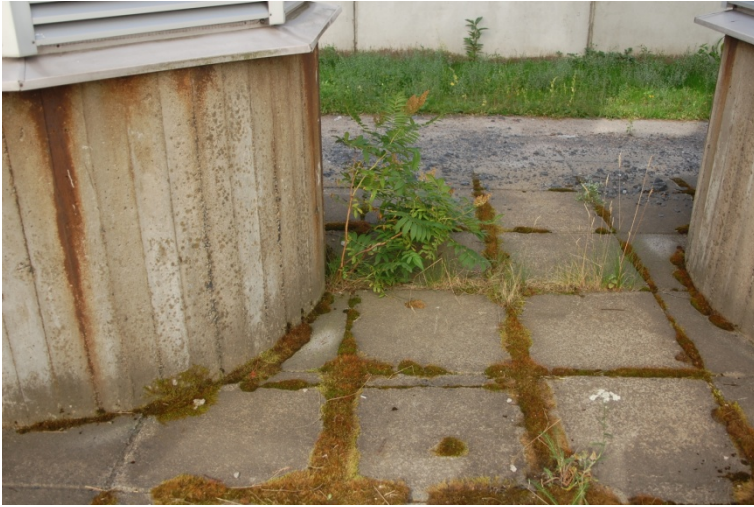
Kuva 31 Ilmastointilaitteistojen kivipinnoitteet kaipaavat kunnostusta.
