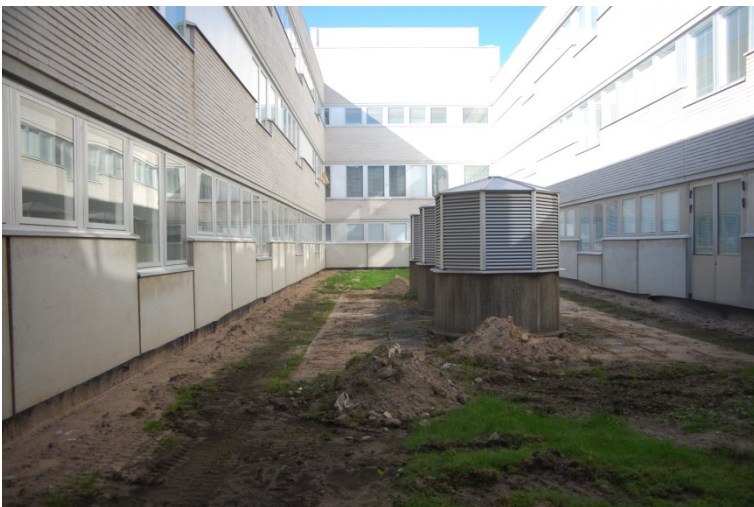
Kuva 16 Laitteistot ovat hyvin koteloitu ja maalattu.
