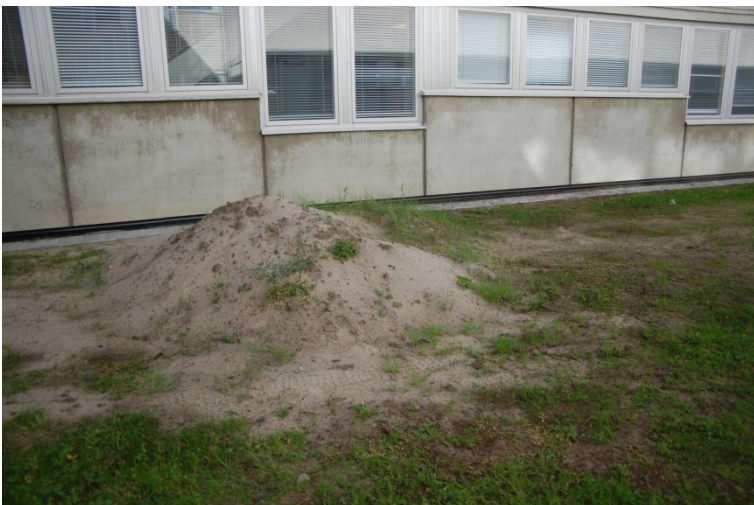
Kuva 30 Alueella on läjitettyä jätemaata.
