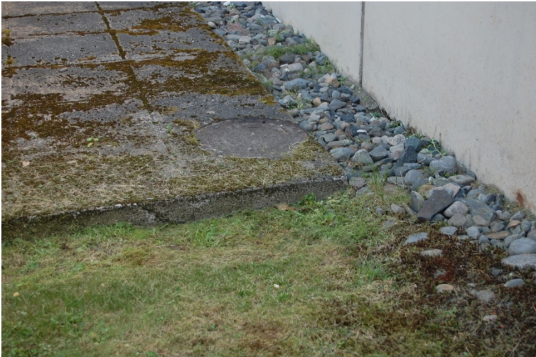
Kuva 18 Alueen seinänvierusta on huonosti asennettua irtokiveä.
