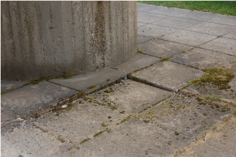
Kuva 29 Kivipinnat kaipaavat uusimista piha-alueella.
