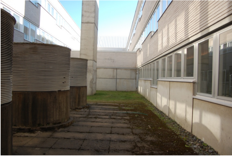
Kuva 17 Sisäpiha-alueen pinnoitteet ovat heikkokuntoisia.
