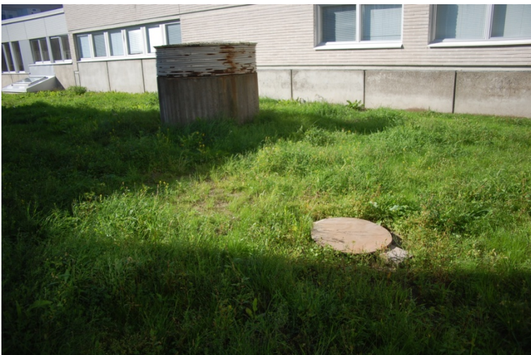
Kuva 33 Pihan rakenteet ovat huonokuntoisia ja paikoittain jopa vaarallisia.
