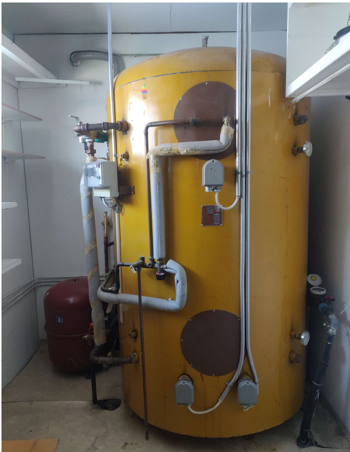
KUVA 1. Kohteen lämminvesivaraaja varusteineen
