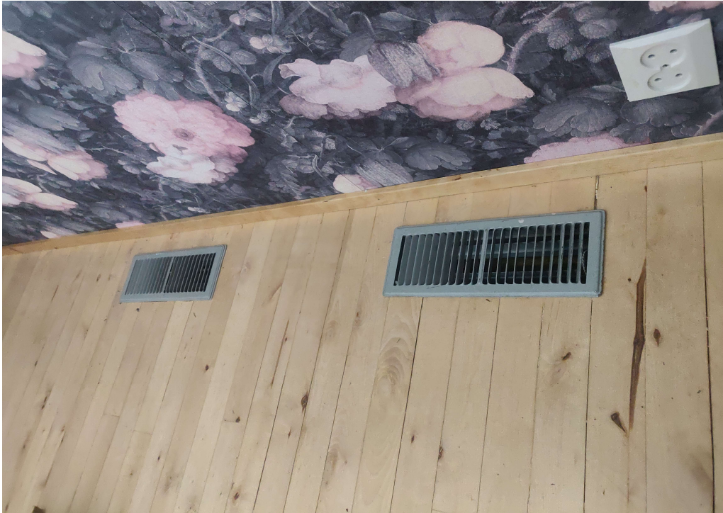
KUVA 2. Ilmalämmitysritilät, joista saadaan huoneeseen lämmintä ilmaa
