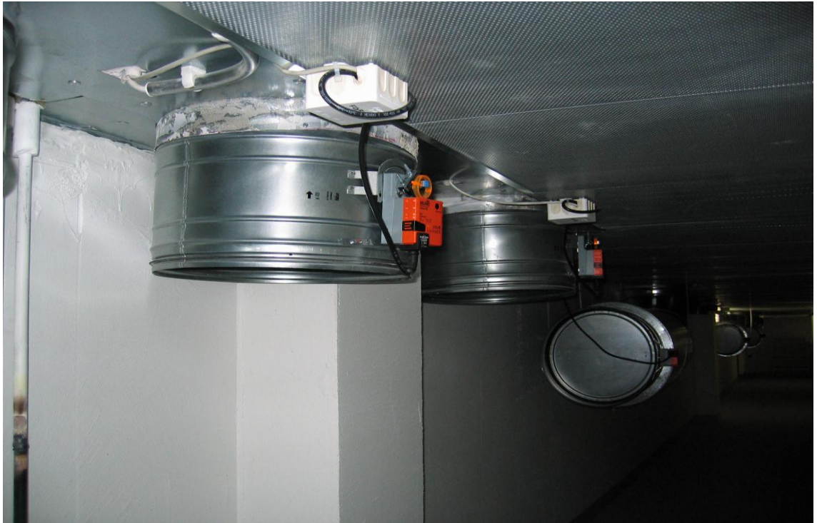
Kuva 7. Luokkahuoneisiin ilmaa jakavat kanavat (kuva Petteri Nurmi).
