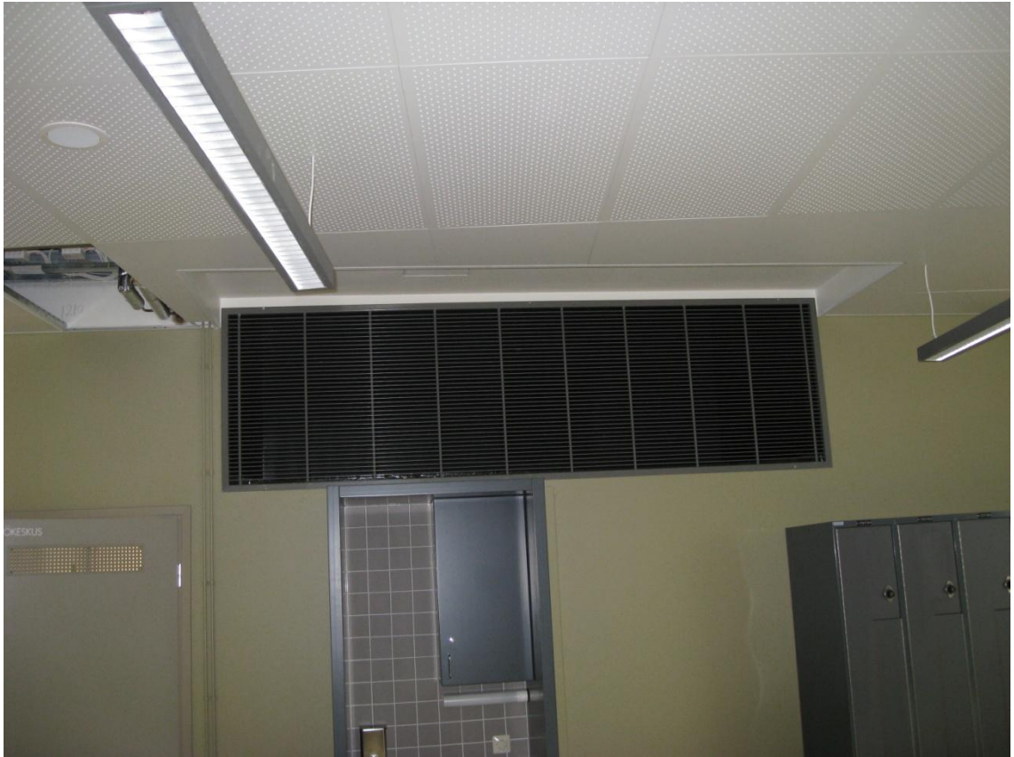
Kuva 12. Säleikkö, joka johtaa poistoilmatorniin, aulasta kuvattuna (kuva Petteri Nurmi).
