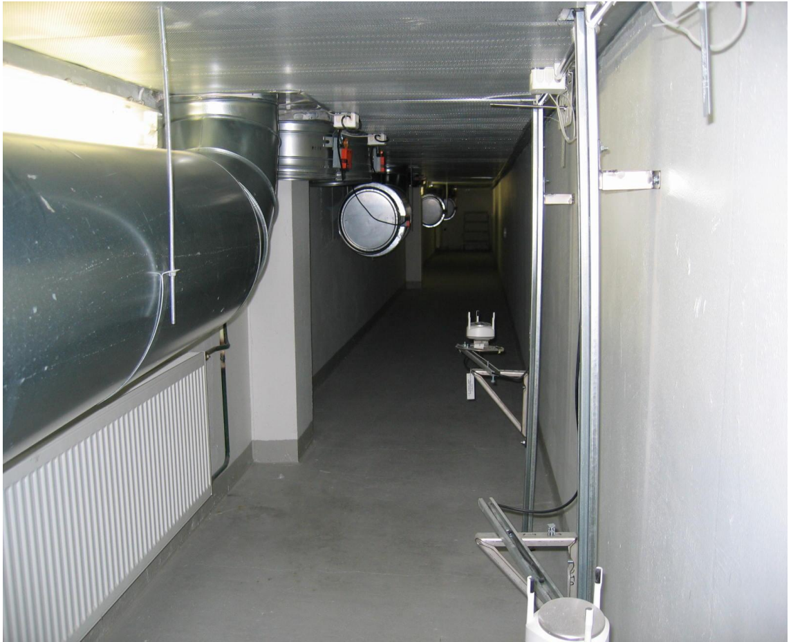
Kuva 6. Tuloilmahormi luokkahuoneisiin (kuva Petteri Nurmi).
