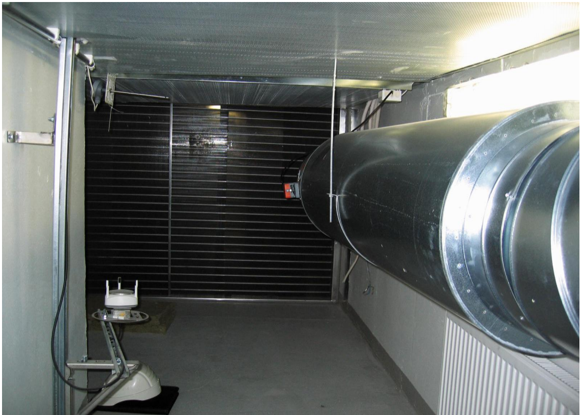
Kuva 8. Tuloilman lämmityspatteri (kuva Petteri Nurmi).
