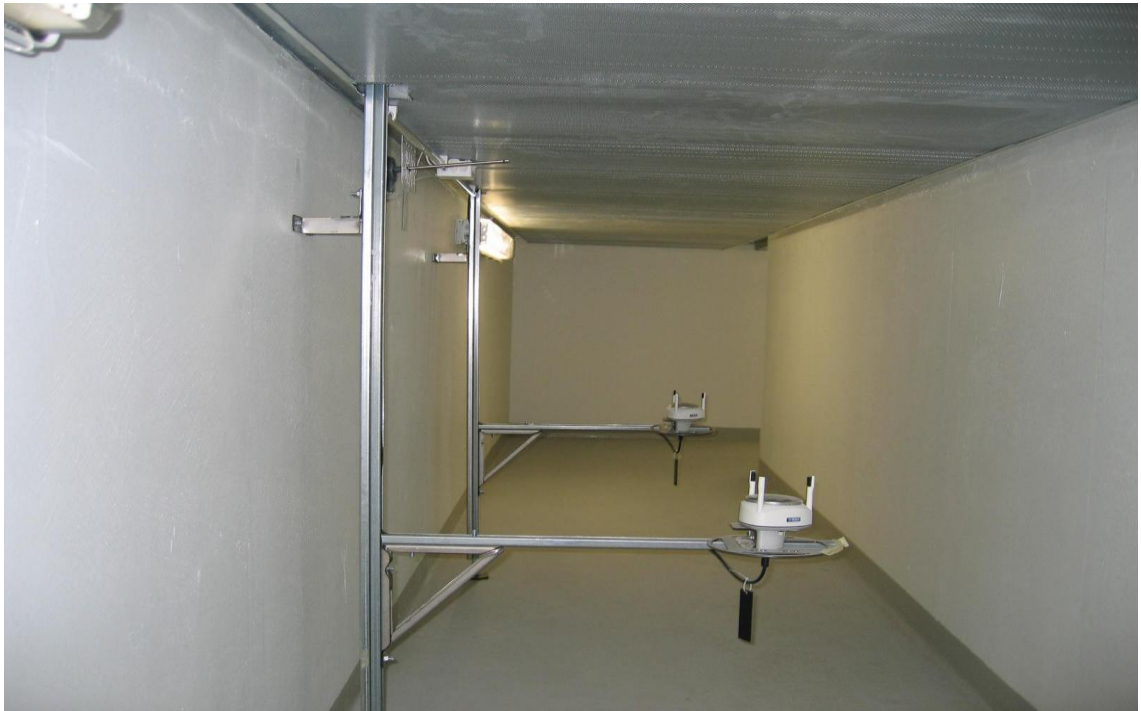
Kuva 5. Tuloilmahormi luokkahuoneisiin (kuva Petteri Nurmi).
