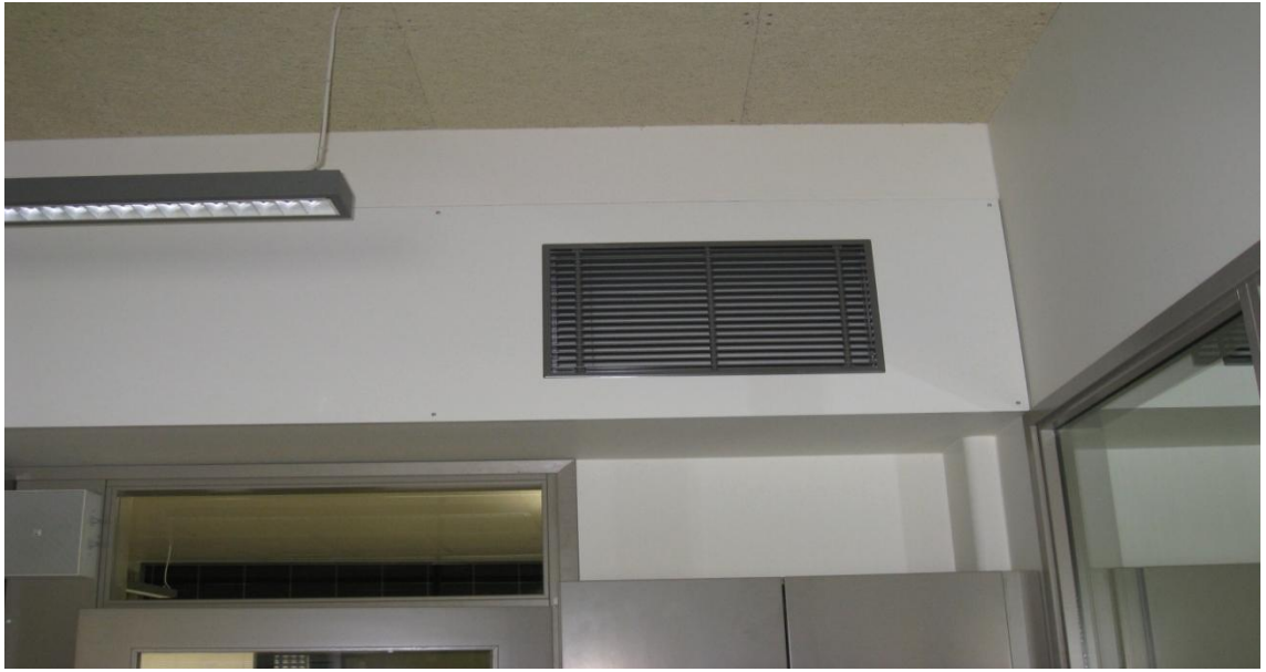
Kuva 10. Luokkahuoneen poisto-/siirtoilmasäleikkö (kuva Petteri Nurmi).
