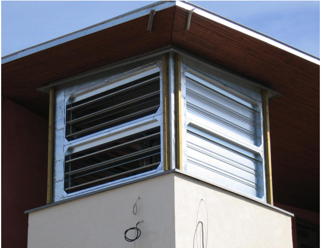
Kuva 2. Raitisilmatornin sulkupellit (kuva Petteri Nurmi).
