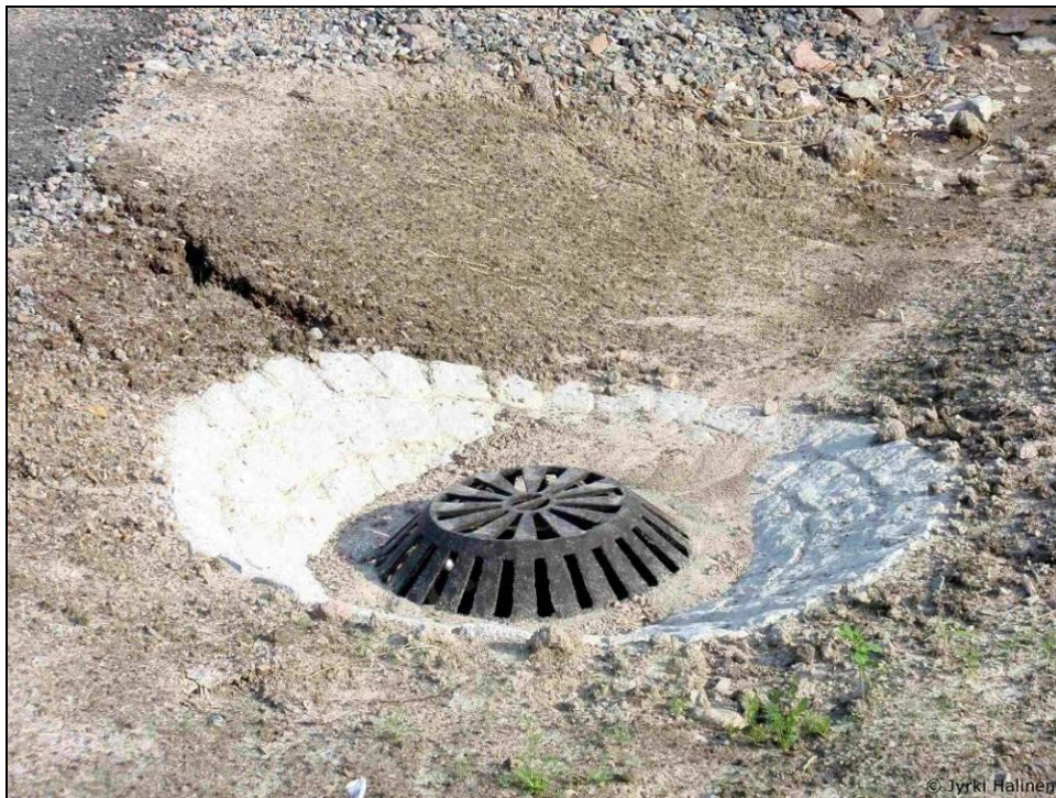
Kuva 9. Korotettu hulevesikaivon kansi ojan pohjalla. (kuvan lähde: Halinen 2011)
