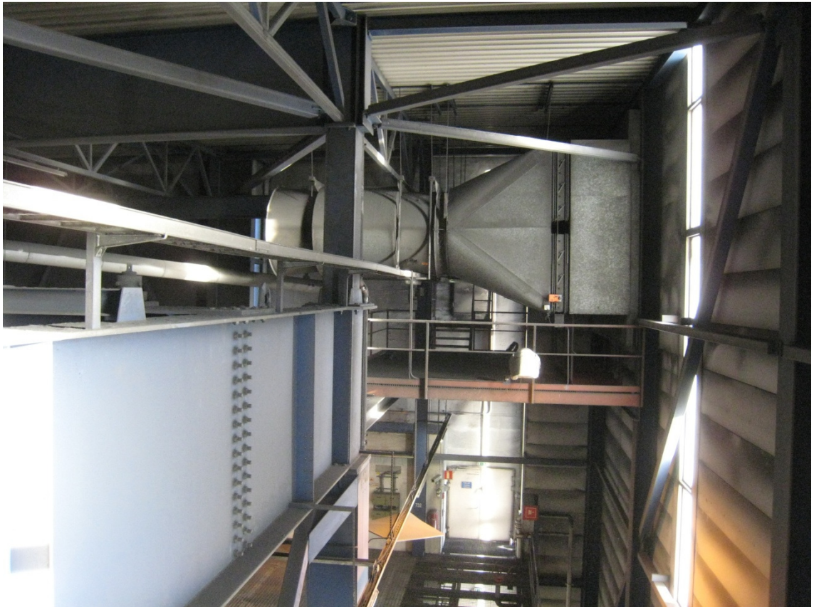
Kuva 8. Kattilahallin poistoilmapuhallin PK121 tasolla +59.00.
