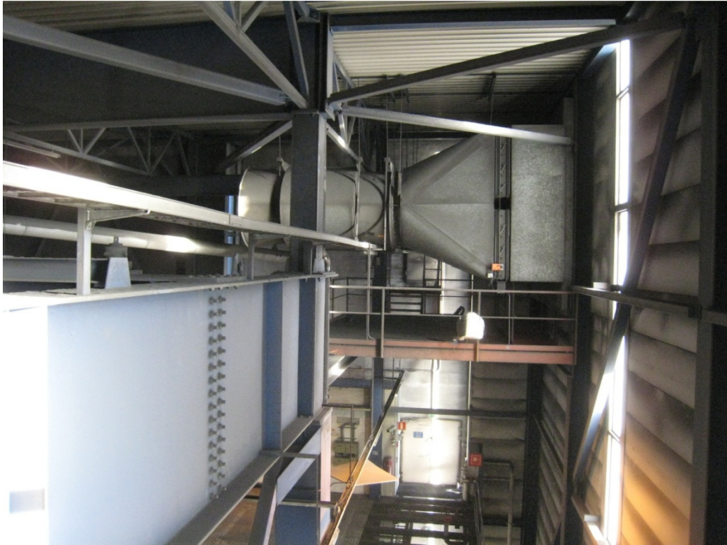
Kuva 25. Kattilahallin poistoilmapuhallin PK123.
