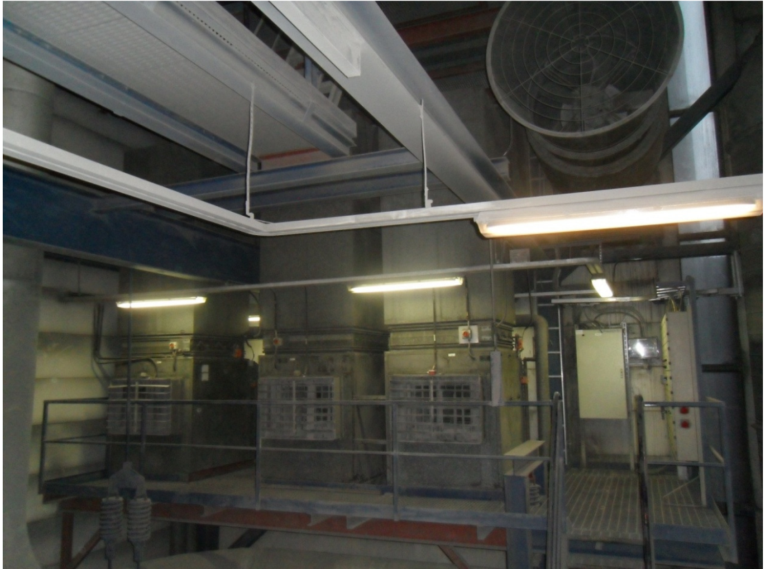
Kuva 7. Kattilahallin tuloilmakoneet TK103–TK105 ja tuloilmapuhallin TF106.
