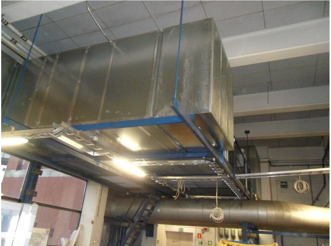
Kuva 21. Uudet tuloilmakoneet TK23 ja TK25.
