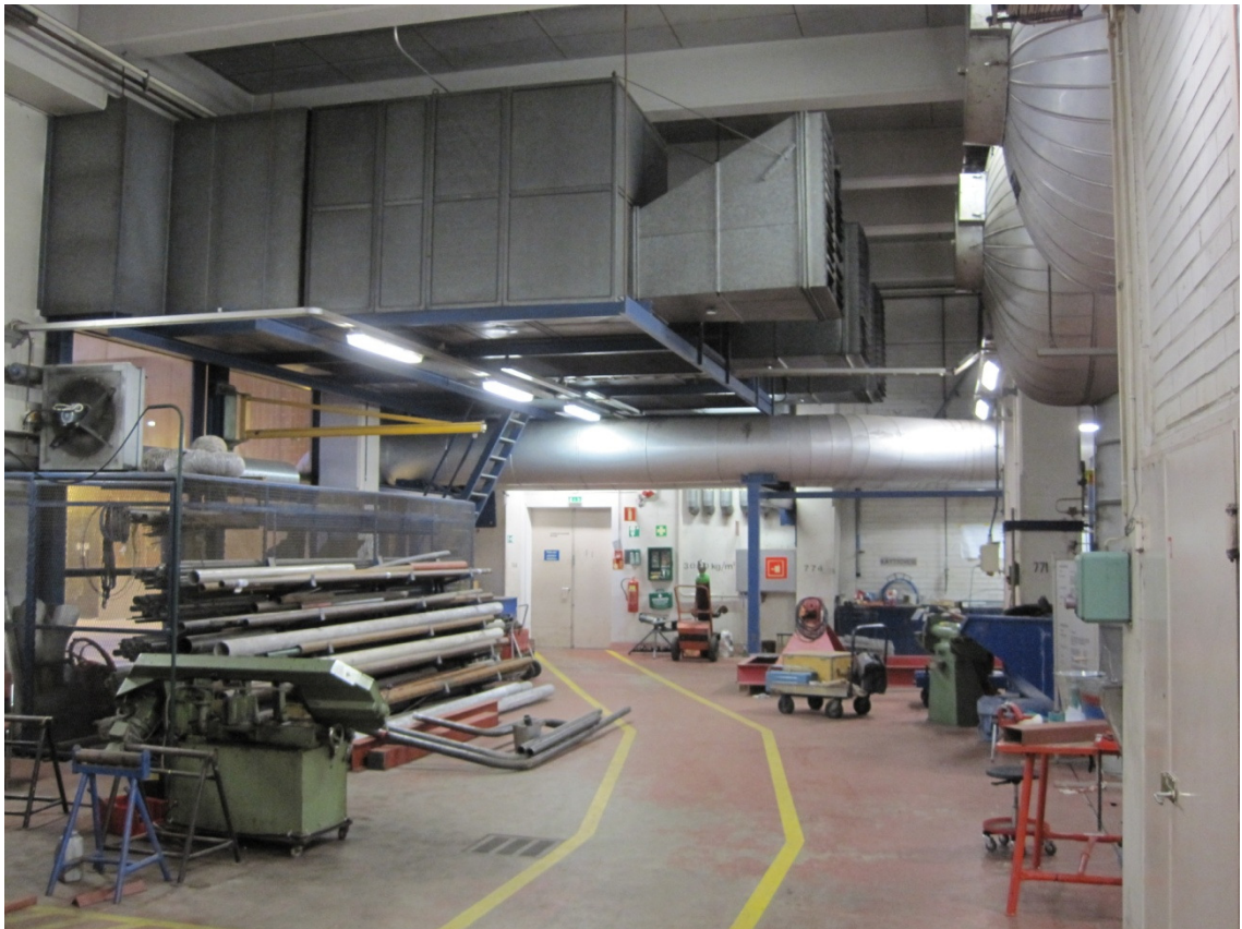
Kuva 20. Vanhat tuloilmakoneet TK23, TK24 ja TK25.
