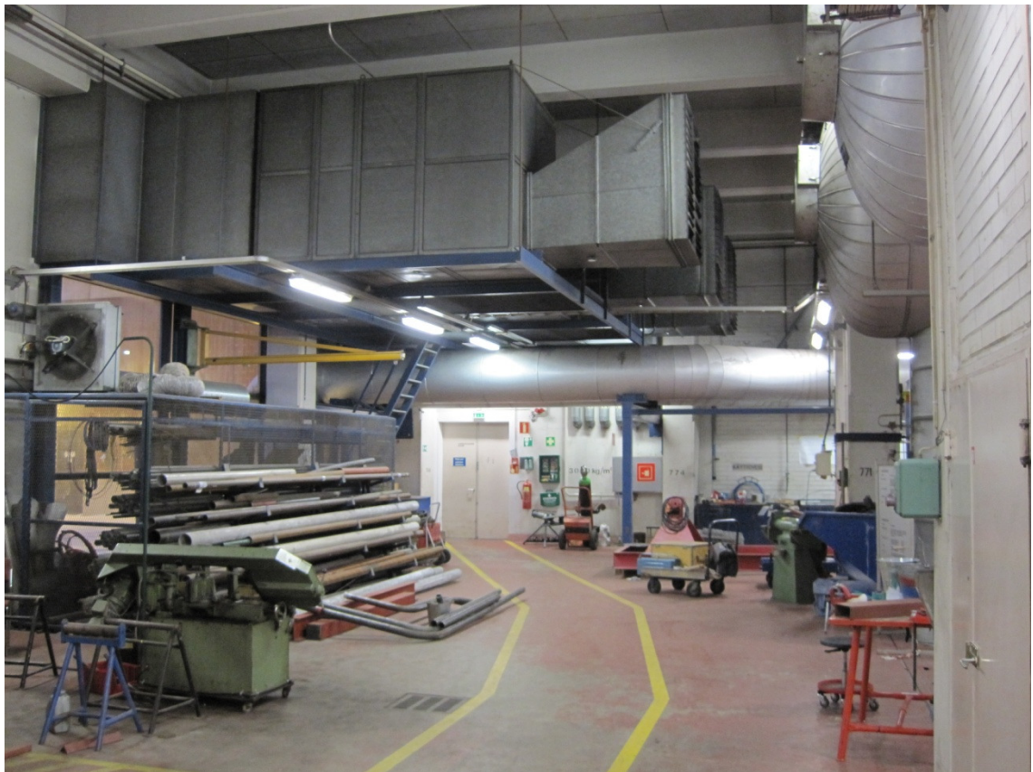
Kuva 12. Turbiinisalin tuloilmakoneet TK23-TK25 tasolla +3.00.
