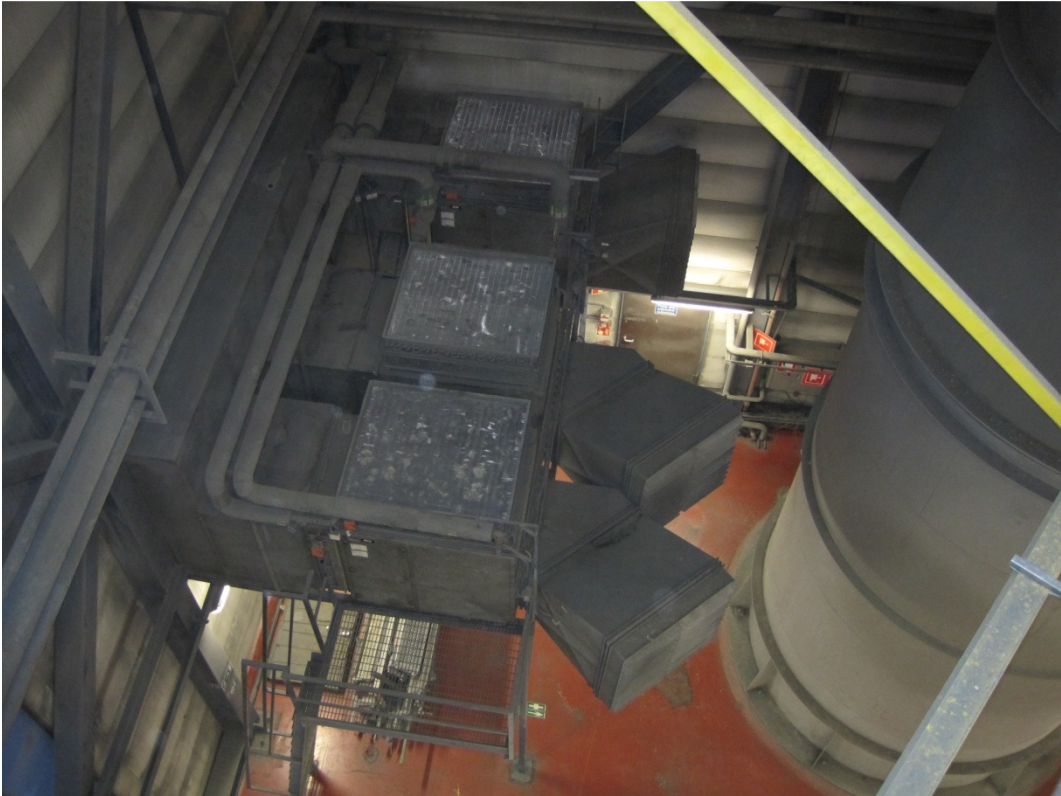
Kuva 22. Kattilahallin nykyiset tuloilmakoneet TK100, TK101 ja TK102.
