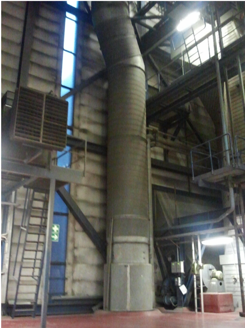
Kuva 9. Kattilahallin sekoituspuhallin KoF99.
