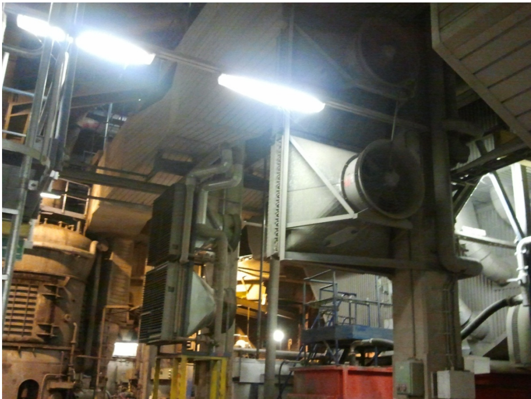
Kuva 26. Kattilahallin kiertoilmakoneet Kok31 ja Kok32.
