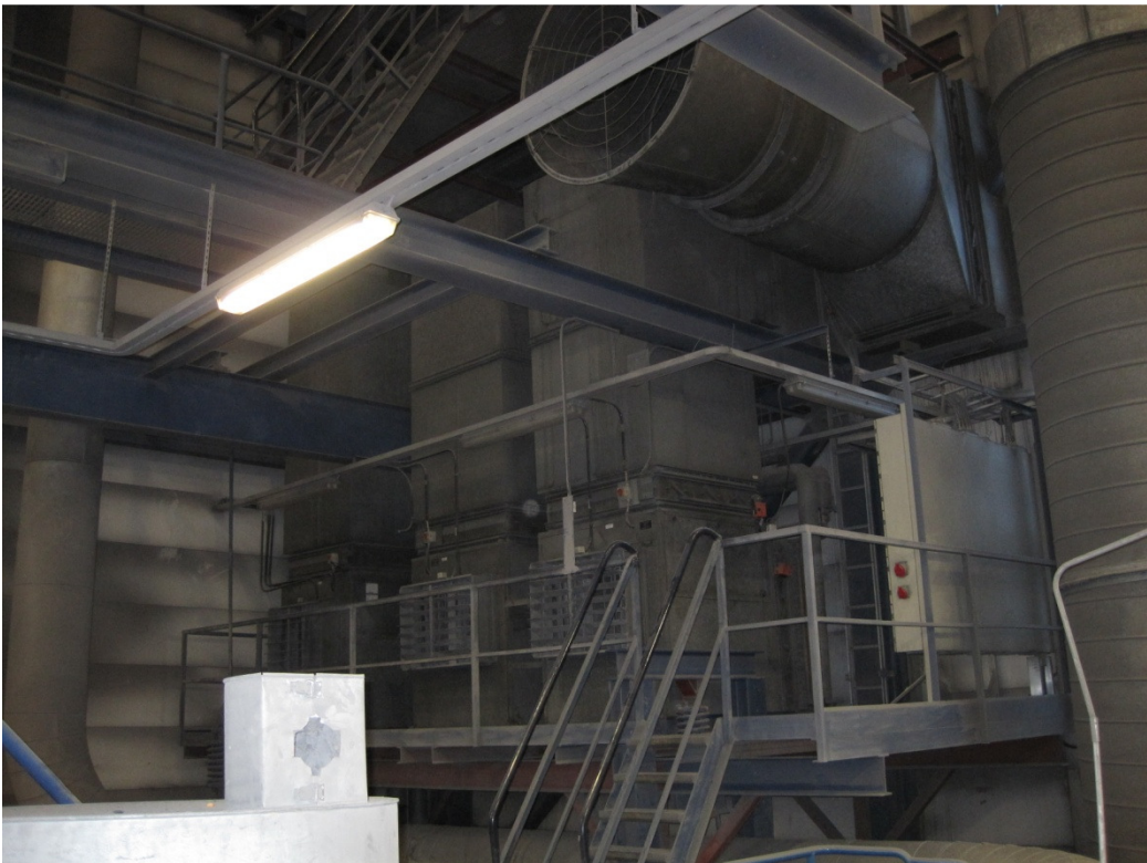
Kuva 23. Kattilahallin nykyiset tuloilmakoneet TK103, TK104 ja TK105.
