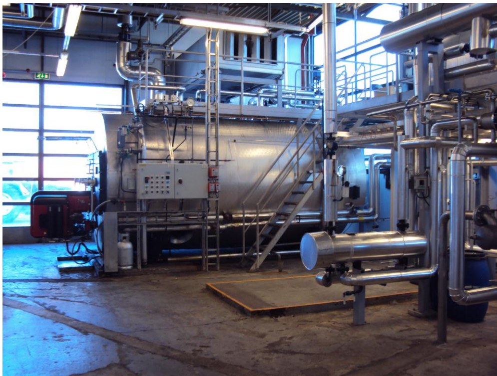
Kuva 14. Orionin/Kiilto Cleanin kattilalaitos sisältää kaksi prosessihöyryn tuotannossa olevaa tulitorvi-tuliputkikattilaa.
