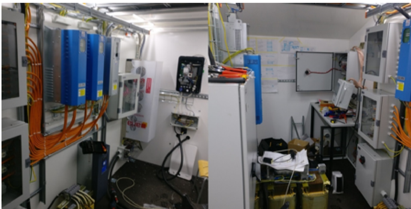
KUVA 2. Energiajärjestelmän sähkötekniistä toteutusta kuvassa 1 esitetyn latausperävaunun sisältä.
