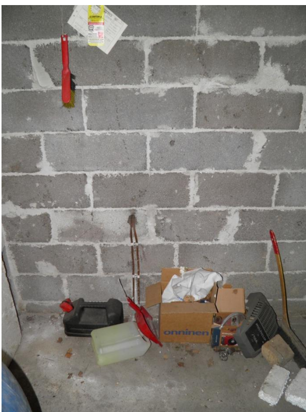
Bild 8: Öljerör som kommer in till pannrummet från oljeförrådet.
