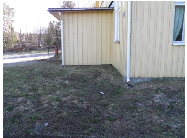
Bild 5: Hög marknivå mot sockel, vattenavledning finns vid dessa hörn.
