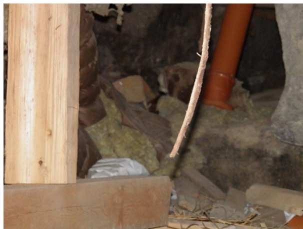
Bild 15: Oisolerat avloppsrör under herr wc.
