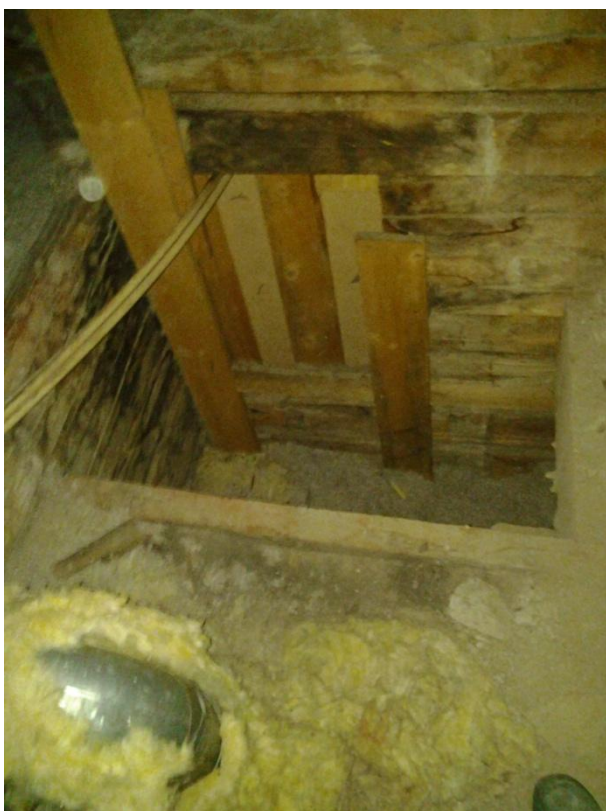
Bild 25: Lucka i mellanbjälklag ovanför korridor
