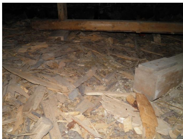
Bild 11: Flismaterial som finns under korridor och wc, bör borttagas.
