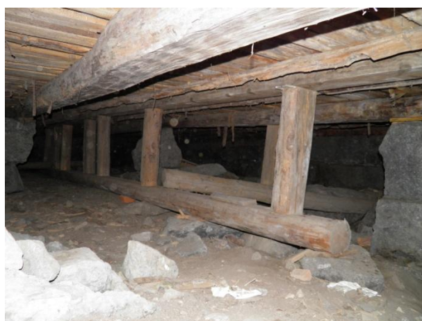
Bild 10: Förstärkningar av 120mm stockar, ligger delvist direkt mot mark.
