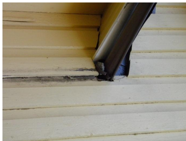
Bild 31: Felaktig takränna vars orsakade skador bör kontrolleras.
