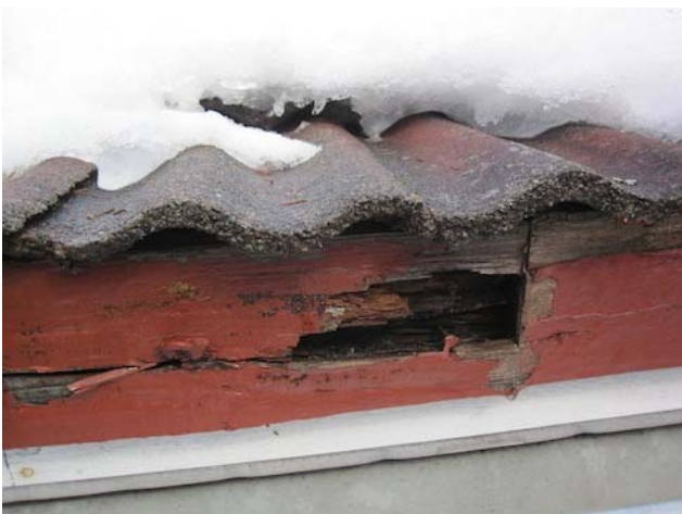
Kuva 5. Mädäntynyt räystäslauta talon eteläpuolella
