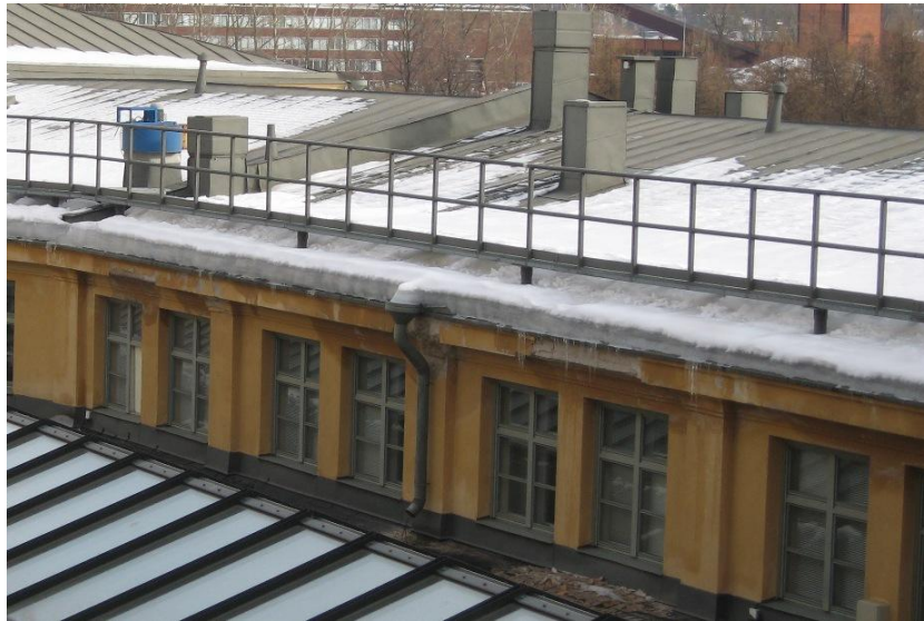
Kuva 13. Jääpato ja kastunut julkisivu (Hönö, 25.5.2012)
