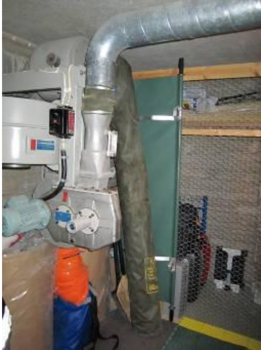
Kuva 19. Väestönsuojan ilmanvaihtokone ja parit.
